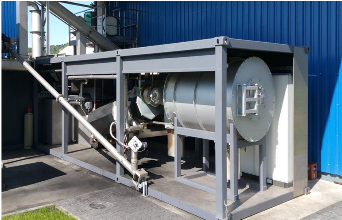
Εικόνα 18 : Η μονάδα πυρόλυσης PyregPX750 ® στην WWTP LORSBACH-GERMANY. Πηγή : (Eliquo Stulz GmbH 2023)
