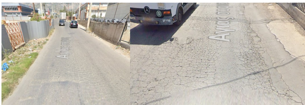
Εικόνα 44: Ρωγμές στο οδόστρωμα της οδού.
