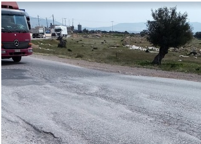
Εικόνα 10: Αυλακώσεις και αλγαιτορικές ρωγμές στον Ασπρόπυργο.
