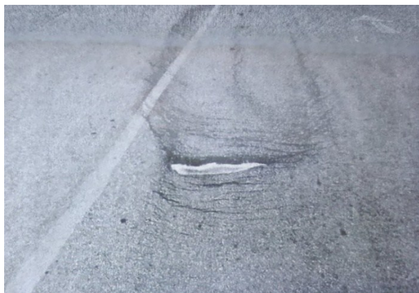
Εικόνα 8: Ρωγμή ανάκλασης (Νικολαΐδης - 2019).
