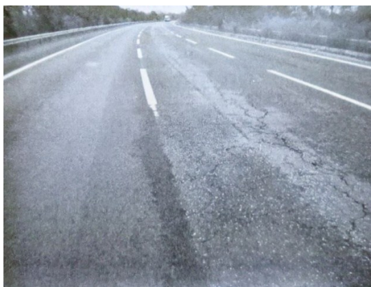
Εικόνα 7: Ρωγμή ανάκλασης (Βιβλίο Νικολαΐδη - 2019).
