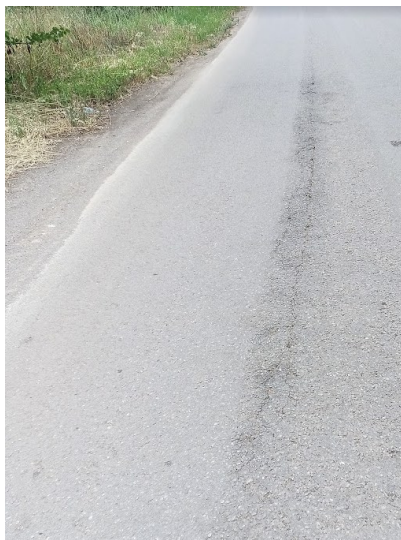
Εικόνα 5: Ρωγή στα άκρα του οδοστρώματος στον Ωρωπό.
