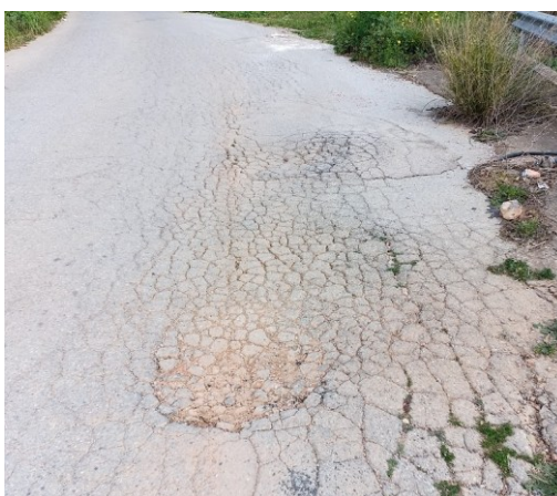
Εικόνα 4: Αλιγατορική ρωγμή στον Ασπρόπυργο.
