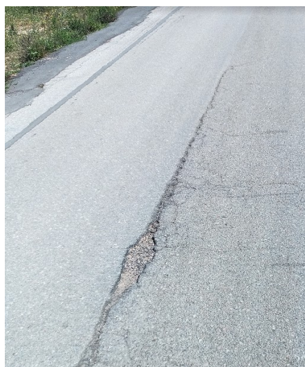
Εικόνα 6: Ρωγμή μεταξύ λωρίδων στον Ασπρόπυργο.
