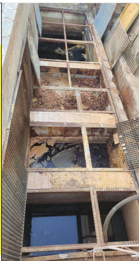
Σχήμα 33. Κύρια δεξαμενή απορροής υγρών αποβλήτων κατά την παραγωγική διαδικασία πυρομαχικών.
