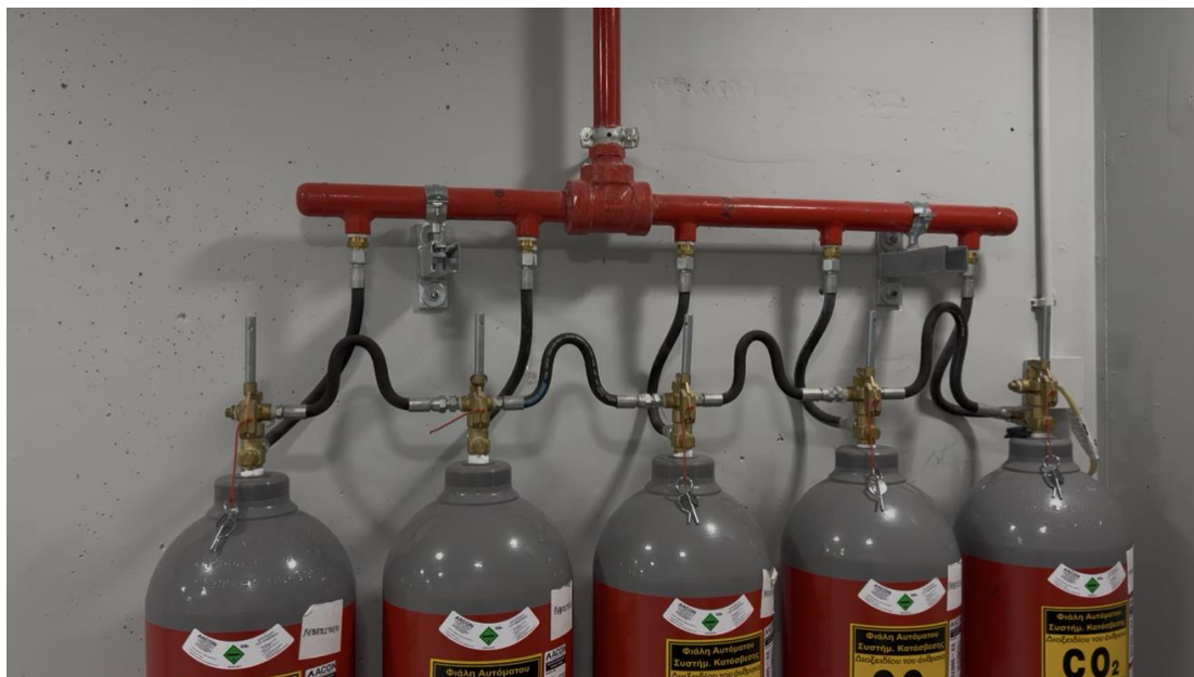
Εικόνα 4.8: Συστοιχία φιαλών συστήματος κατάσβεσης CO 2 .
