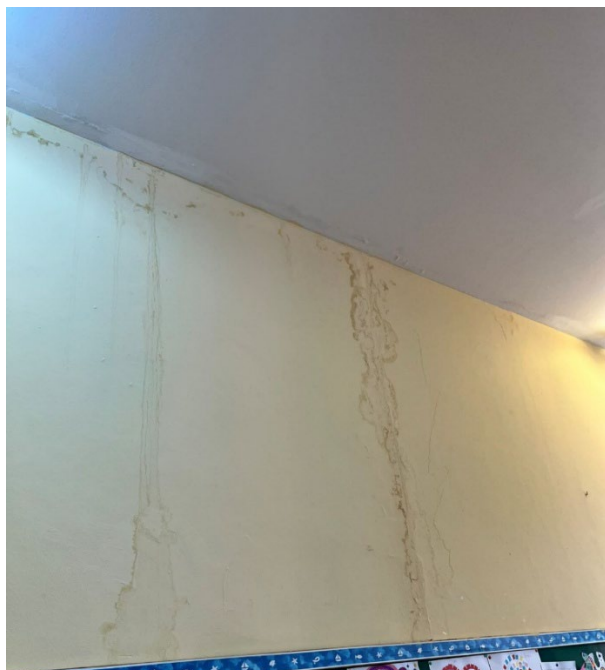
Εικόνα 13. Υγρασία σε τοιχοποιία
