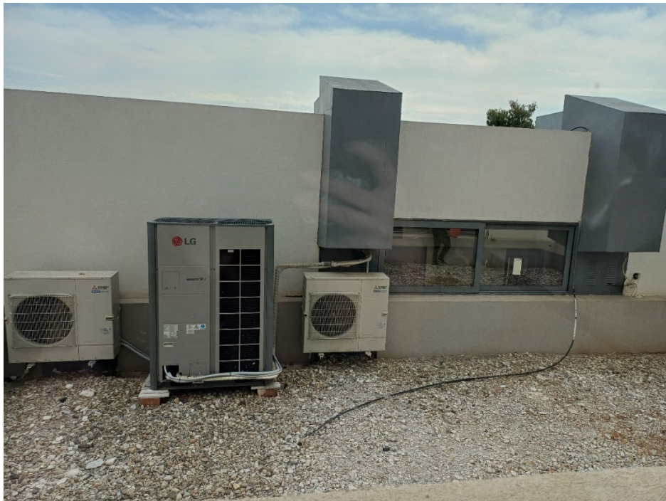
Εικόνα 40. Φθορές σε μόνωση
