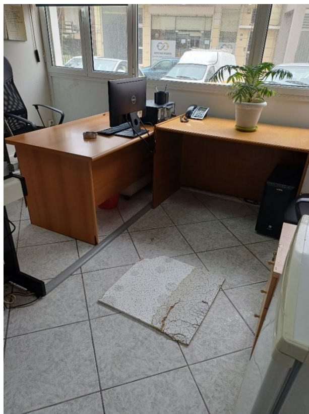
Εικόνα 33. Πτώση τμημάτων ψευδοροφής
