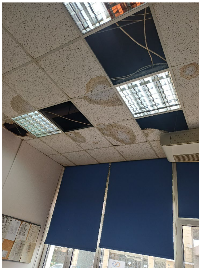
Εικόνα 36. Πτώση τμημάτων ψευδοροφής, εκτεθειμένες καλωδιώσεις
