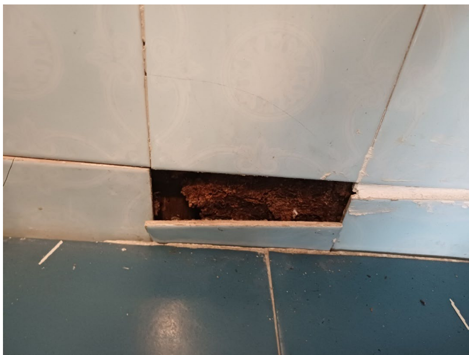
Εικόνα 35. Φθορές σε τοιχοποιίες χώρων υγιεινής
