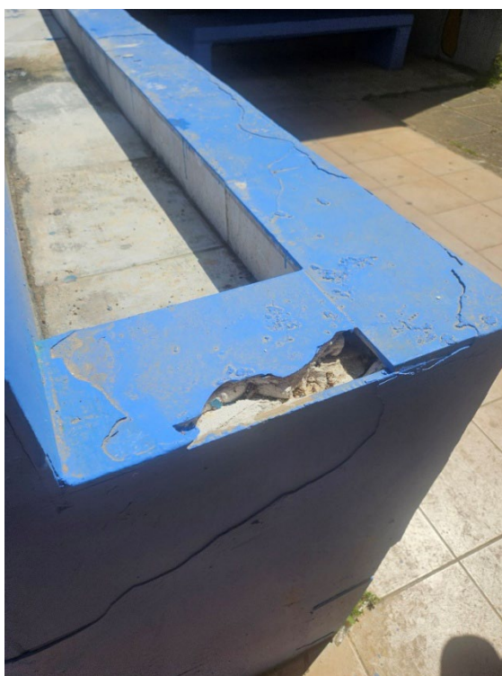
Εικόνα 10. Φθαρμένο στηθαίο, αποκόλληση υλικών
