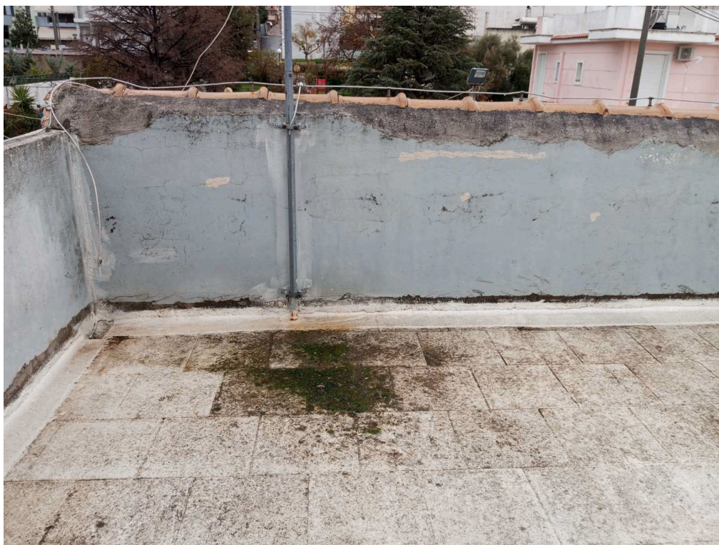
Εικόνα 23. Μη πραγματοποίηση μόνωσης
