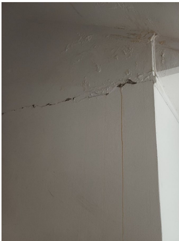
Εικόνα 38. Ρωγμές σε τοιχοποιία
