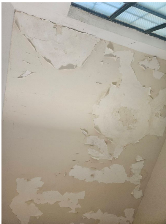
Εικόνα 9. Φθορές οροφής λόγω υγρασίας
