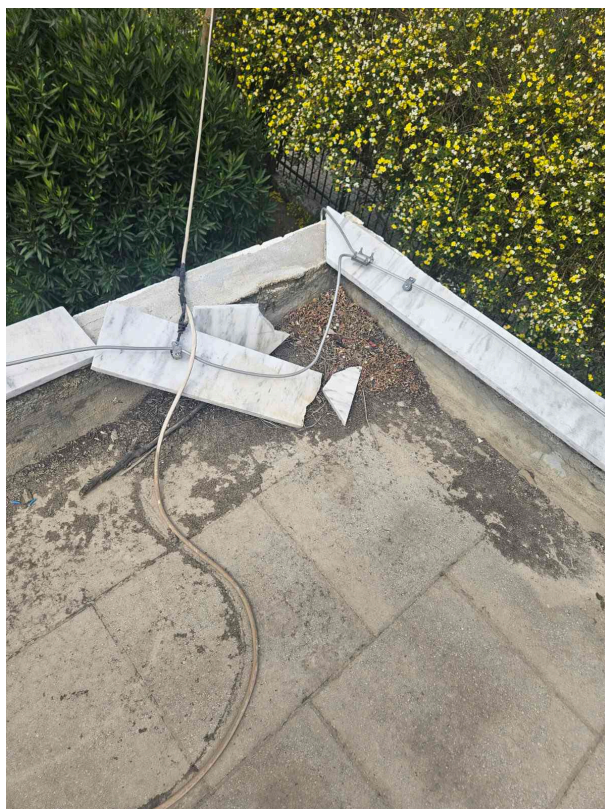
Εικόνα 20. Φθορά στηθαίου, αποκόλληση υλικών
