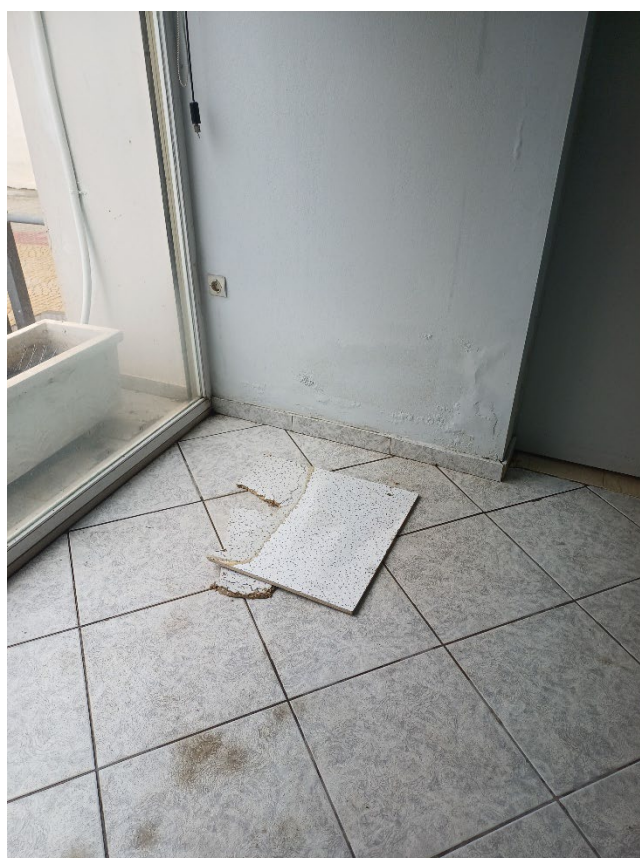
Εικόνα 32. Πτώση τμημάτων ψευδοροφής
