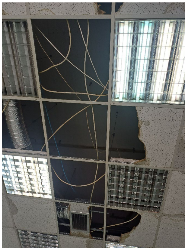
Εικόνα 34. Πτώση τμημάτων ψευδοροφής, εκτεθειμένες καλωδιώσεις
