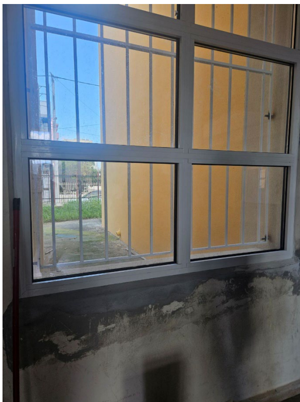
Εικόνα 3. Φθορά τοιχοποιίας λόγω υγρασίας
