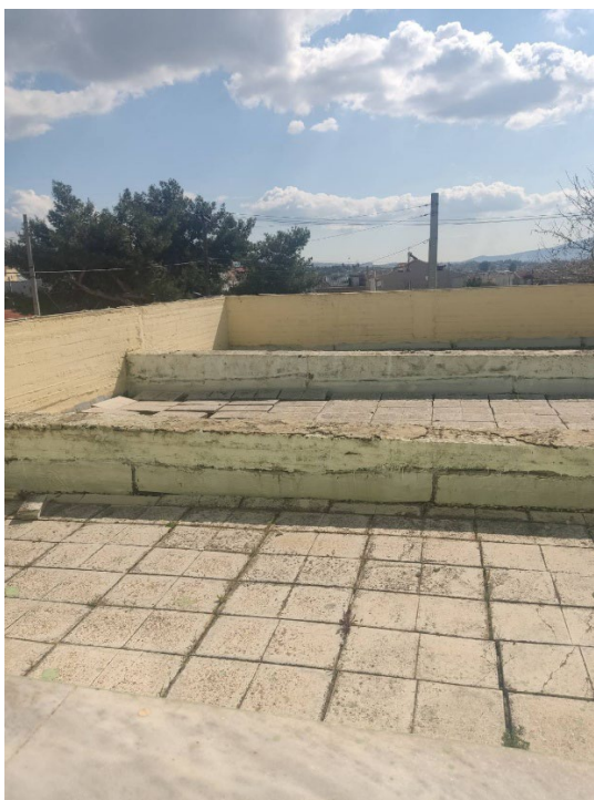
Εικόνα 5. Μη πραγματοποίηση μόνωσης
