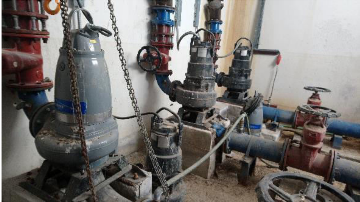
Εικόνα 4.9. Αντλιοστάσιο καθίζησης ΜΚΑ ΒΠΠΕ Πατρών.
