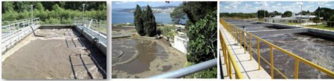
Εικόνα 3.3. Η δεξαμενή ενεργού ιλύος ή δεξαμενή αερισμού [40],[41]. Παραδείγματα από βιολογικούς καθαρισμούς στην Ελλάδα.
