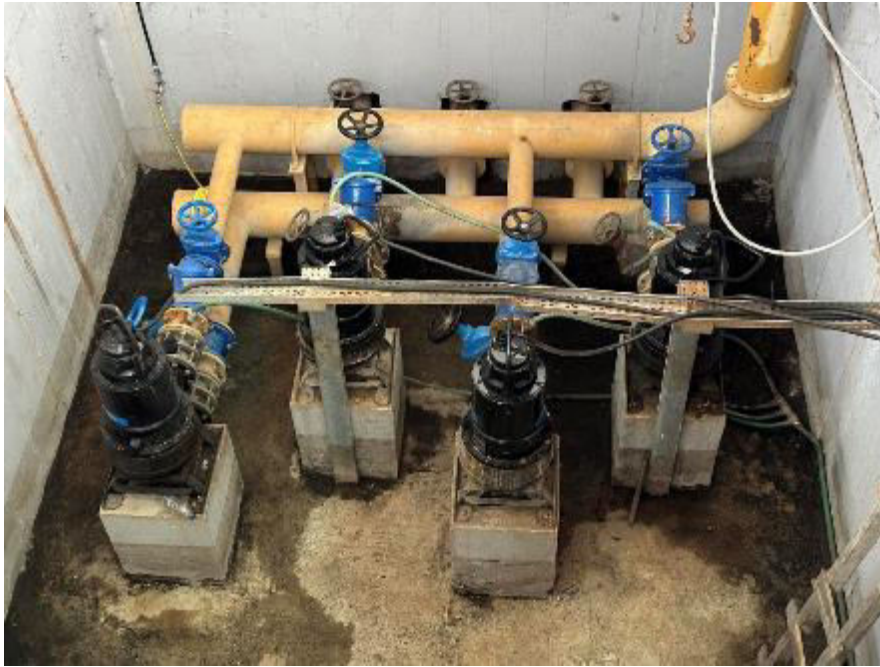
Εικόνα 4.5. Αντλιοστάσιο ανύψωσης λυμάτων ΜΚΑ ΒΠΠΕ Πατρών.
