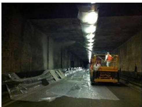
ΕΙΚΟΝΑ 5.9.: Εφαρμογή φωτοκαταλυτικών συστημάτων και λαμπών υπεριώδους ακτινοβολίας στη σήραγγα Leopold II στις Βρυξέλλες (πηγή: Boonen et al., 2014)
