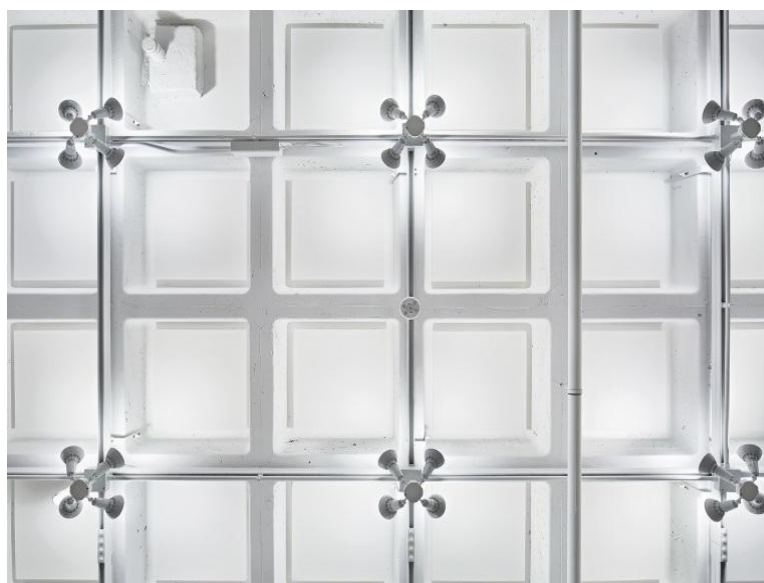
Εικόνα 21. Ενσωμάτωση του φωτισμού στον υφιστάμενο δομικό κάναβο της οροφής. Πηγή Εικόνας: Keane, 2017
