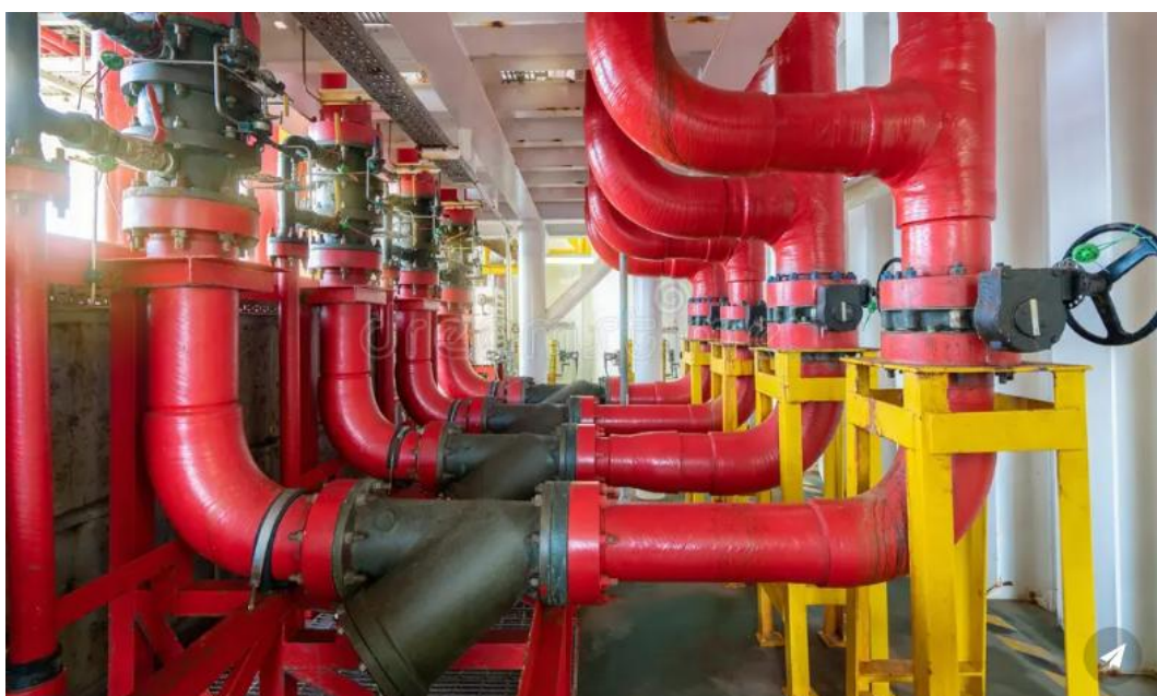
Εικόνα 8: Συστήματα πυρόσβεσης σε υπεράκτιες κεντρικές πλατφόρμες επεξεργασίας πετρελαίου και φυσικού αερίου (πηγή https://gr.dreamstime.com )
