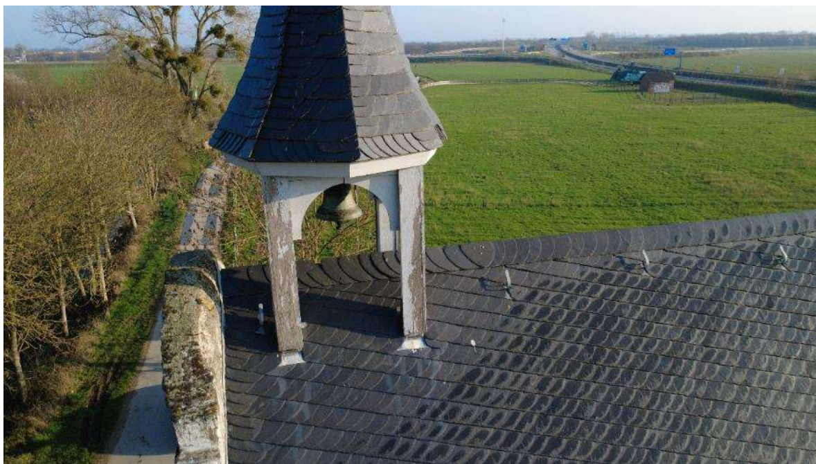
Εικόνα 32. Φθορά ξύλινων τμημάτων του καμπαναριού και υγρασία. (Πηγή: Φωτογραφία συγγραφέα)
