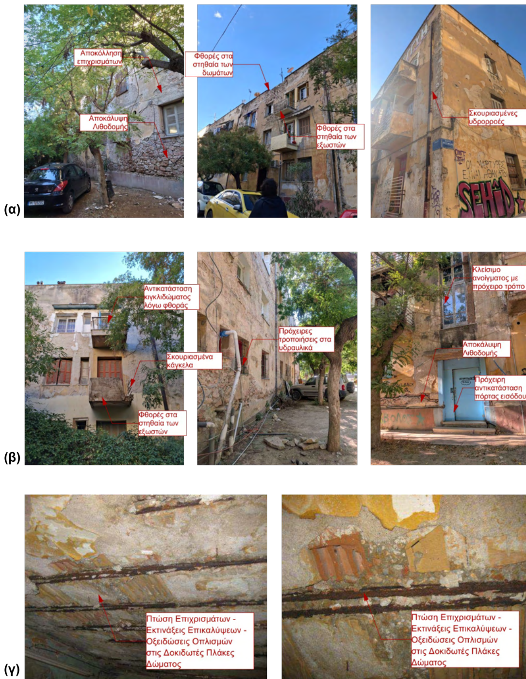
Εικόνα 72: (α) Εξωτερικές εικόνες που δείχνουν τις φθορές. Πηγή: Προσωπικό αρχείο και Ιδία επεξεργασία (β) Εξωτερικές εικόνες που δείχνουν τις φθορές. Πηγή: Προσωπικό αρχείο και Ιδία επεξεργασία (γ) Φθορές στην πλάκα οροφής των κοινόχρηστων πλυσταριών στα δώματα. Πηγή: ΤΕΥΧΟΣ ΤΕΧΝΙΚΗΣ ΕΚΘΕΣΗΣ ΚΑΙ ΥΠΟΛΟΓΙΣΤΙΚΗΣ ΤΕΚΜΗΡΙΩΣΗΣ, Εγκεκριμένης Πολεοδομικής Μελέτης με Α/Α Πράξης 36956/20-05-2019, 2019
