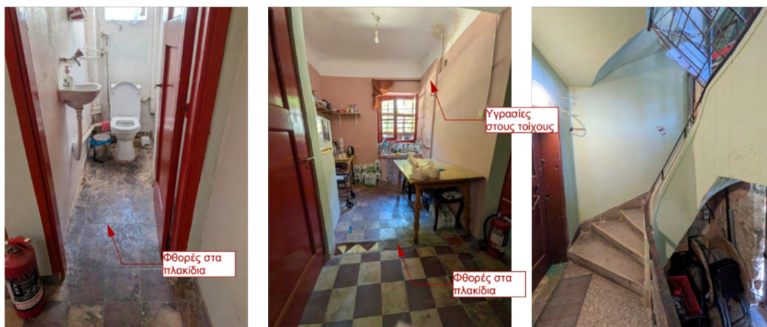
Εικόνα 73:Εσωτερικές εικόνες που δείχνουν τις φθορές. Πηγή: Προσωπικό αρχείο και Ιδία επεξεργασία
