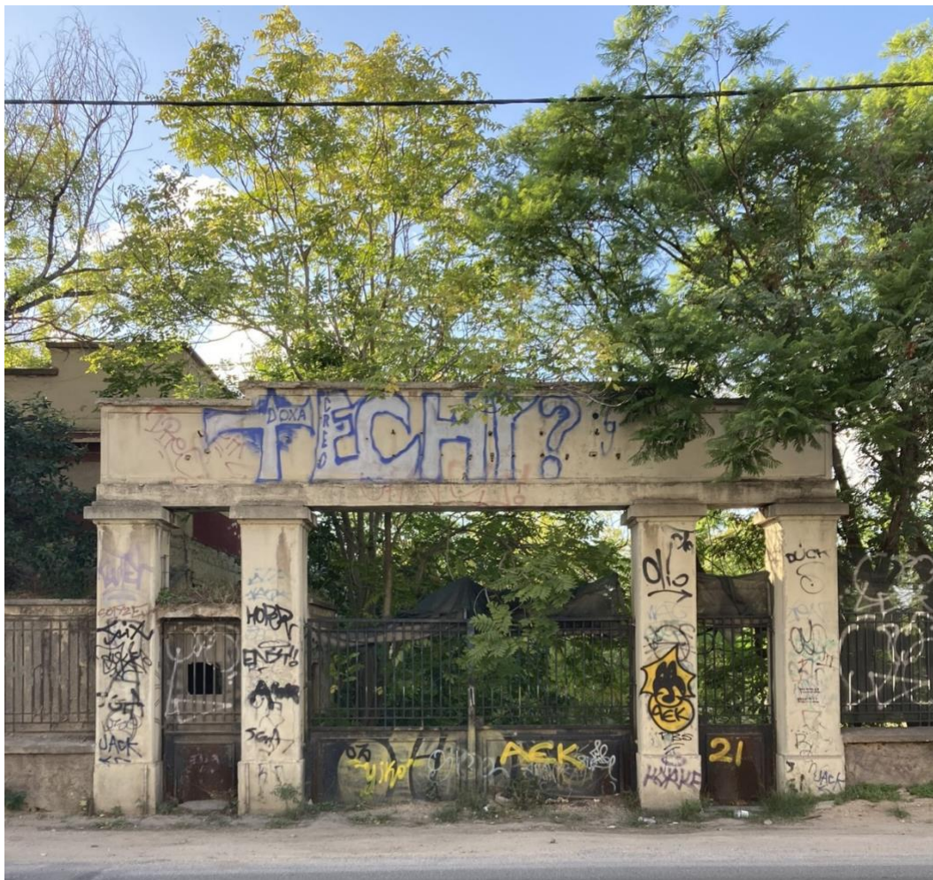
Εικόνα 7 Η κεντρική πύλη του εργοστασίου, μετά την κλοπή της μαρκίζας από αγνώστους
