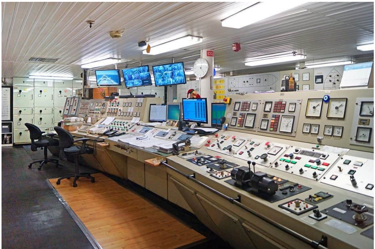
Εικόνα 4.2: Χώρος Αίθουσας Ελέγχου Μηχανής (ECR) σε εμπορικό πλοίο
