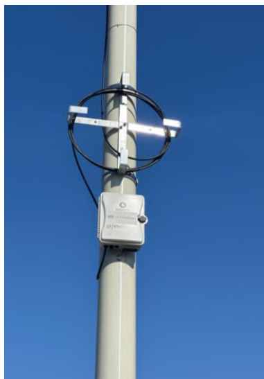
Εικόνα 6-11 Εναέριος οπτικός σύνδεσμος και εξοπλισμός διανομής οπτικών ινών εγκατεστημένος σε στύλο δικτύου στο πλαίσιο ανάπτυξης του έργου UFBB.
