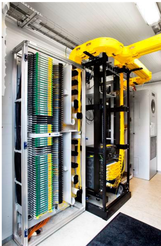
Εικόνα 4-7 Εγκατάσταση ενεργών και παθητικών Optical Distribution Frames (ODFs) σε Point of Presence (POP) δικτύου FTTH.
