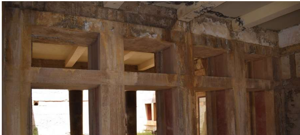
Εικόνα 18 Μέγαρο Βασιλέως: Απορροές ομβρίων υδάτων, εξανθήσεις αλάτων, λευκές συγκεντρώσεις αλάτων και φαινόμενα βιολογικής φθοράς στις αναστηλώσεις των πολύθυρων από οπλισμένο σκυρόδεμα (προσωπικό αρχείο Ζάχου Μ.)
