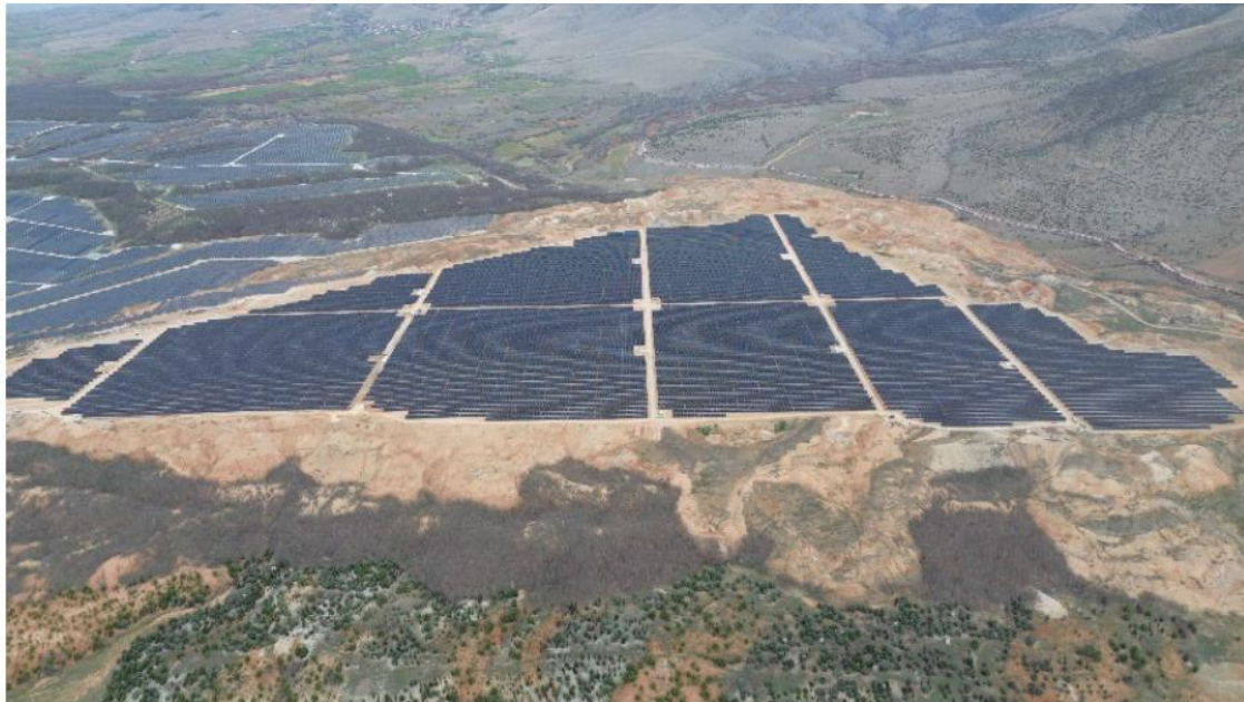
Εικόνα 21: Φωτοβολταϊκός σταθμός ισχύος 171 MW σε πρώην χώρο απόθεσης του Λιγνιτικού Κέντρου Δυτικής Μακεδονίας
