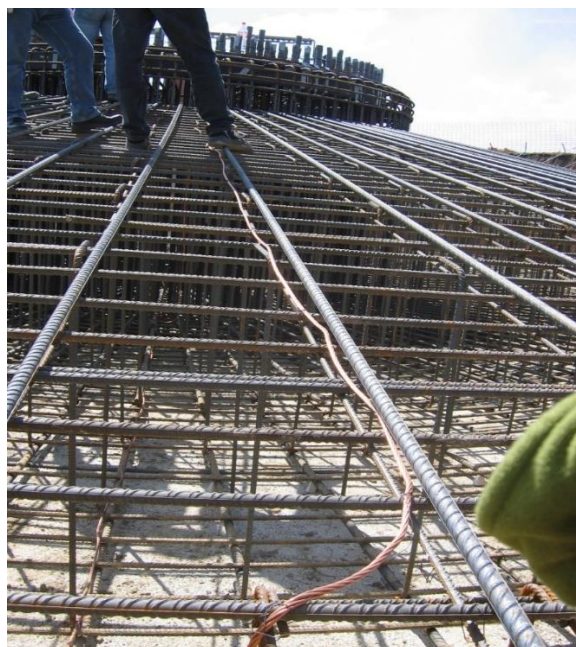
Εικόνα 6.9: Θεμελιακή γείωση στον πυλώνα της ανεμογεννήτριας
