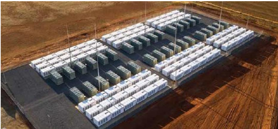
Σχήμα 2.4. Έργο ESS Hornsdale στη Νότια Αυστραλία. (Πηγή: Hornsdale Power Reserve, 2019).
