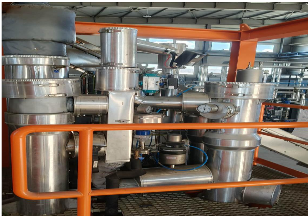
Εικόνα 12. Συστοιχία συμπυκνωτών των πτητικών αερίων, μεταλλικά φίλτρα (strainers) αέριων πτητικών όπου με by pass επιστέφουν στον συμπυκνωτή.
