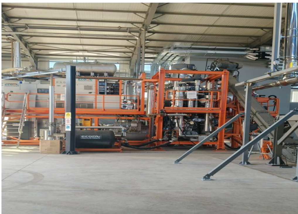
Εικόνα 15. Γενική άποψη της εγκατάστασης θερμικής εκρόφησης.
