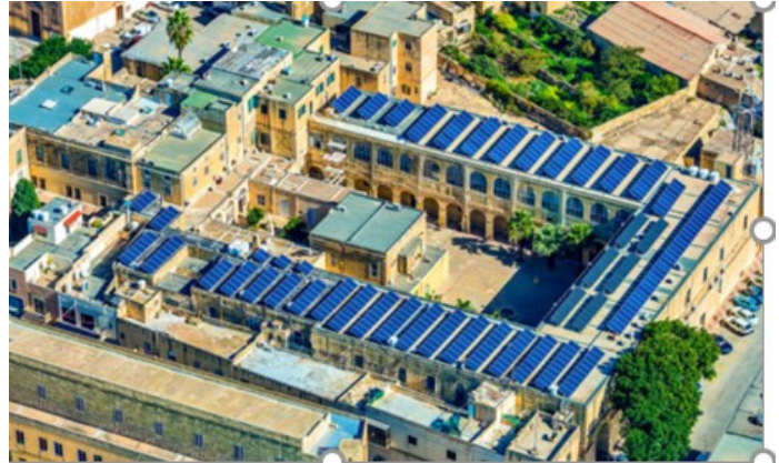
Εικόνα 2.2 Φωτοβολταικά σε δημόσιο κτίριο ( Πηγή: https://www.sustaineurope.com )
