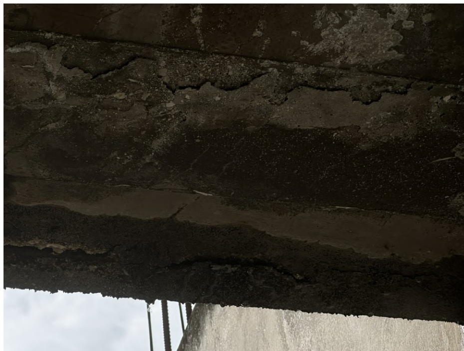
Εικόνα 33 - Πρόβλημα υγρασίας στους προβόλους του κτιρίου(2)
