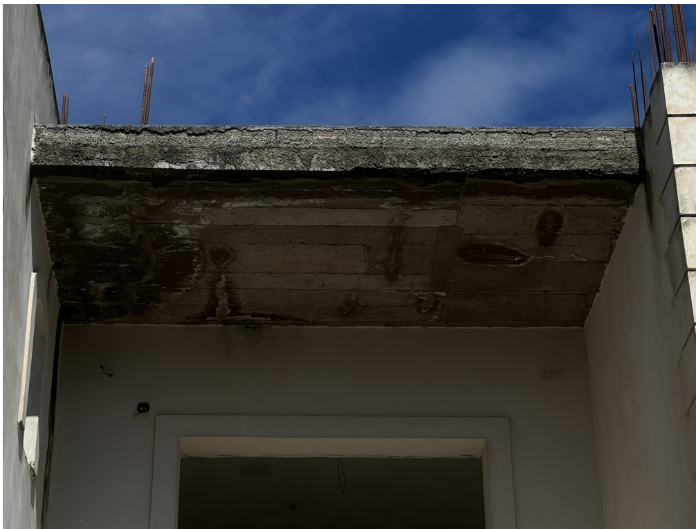
Εικόνα 32 - Πρόβλημα υγρασίας στους προβόλους του κτιρίου(1)
