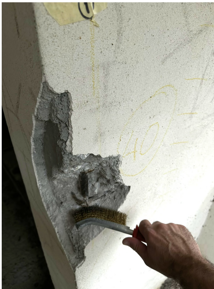
Εικόνα 34 - Αποκάλυψη οπλισμού στα υποστυλώματα
