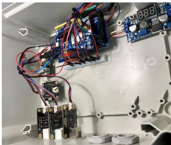
Εικόνα 18. Συνδεσμολογία στο εσωτερικό του σταθμού
