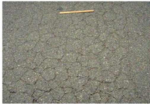
Εικόνα 3 Μεσαίας έντασης ρωγμές τύπου αλιγάτορα
