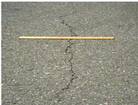
Εικόνα 2 Χαμηλής έντασης ρωγμές τύπου αλιγάτορα
