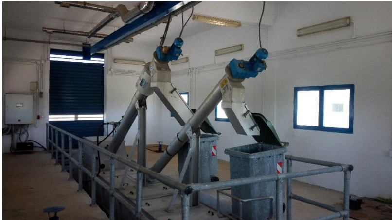
Εικόνα 10: Μονάδα Βοθρολυμάτων ( Δ.Ε.Υ.Α.Σ , 2023)
