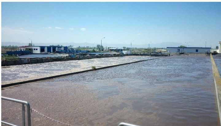
Εικόνα 12: Δεξαμενή Αερισμού Β ( Δ.Ε.Υ.Α.Σ. , 2023 )
