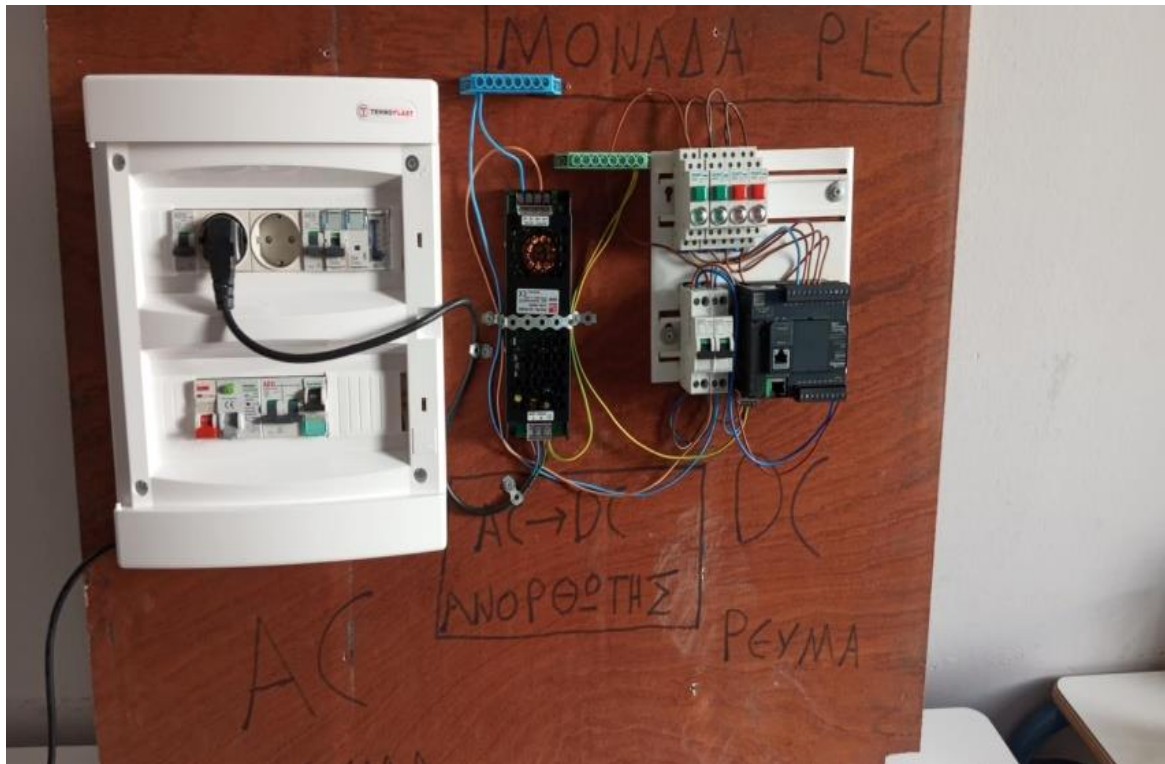
Εικόνα 11 Προσωπικό αρχείο σπουδαστή Κόκκου Θεόδωρου. Εγκατάσταση μονάδας plc με εισόδους και τροφοδοσία από ανορθωτή Εσπερινό ΕΠΑΛ Κω σχολική χρονιά 2024-2025.
