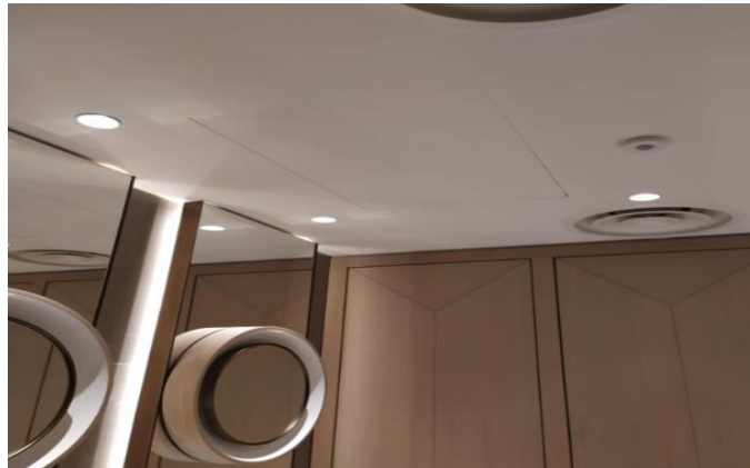
Εικόνα 39 Τουαλέτες ξενοδοχείου. Έναυση φωτιστικών μέσω αισθητήρα microwave. Προσωπικό αρχείο Ζεντύλη Ιωάννη.
