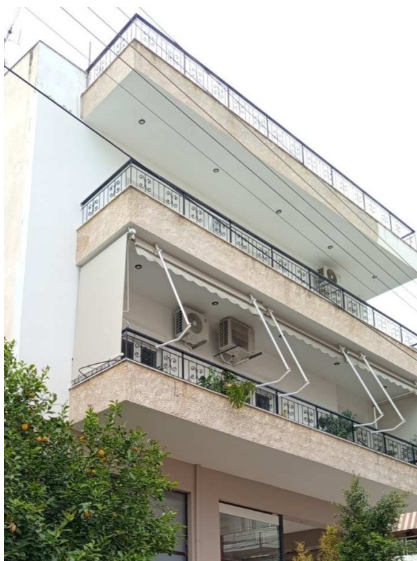
Εικόνα 12 : Θερμογέφυρα εξωτερικής τοιχοποιίας - εξώστη
