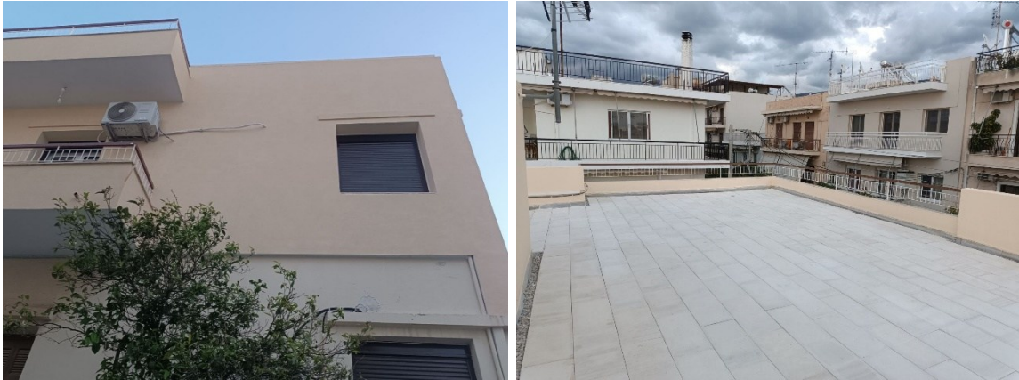
Εικόνα 13 : Θερμογέφυρα εξωτερικής τοιχοποιίας - δώματος με στηθαίο
