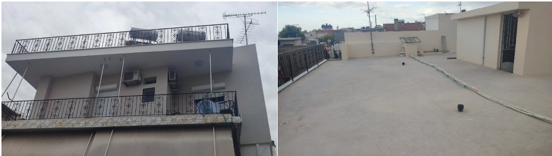
Εικόνα 14 : Θερμογέφυρα εξωτερικής τοιχοποιίας - δώματος με προεξοχή
