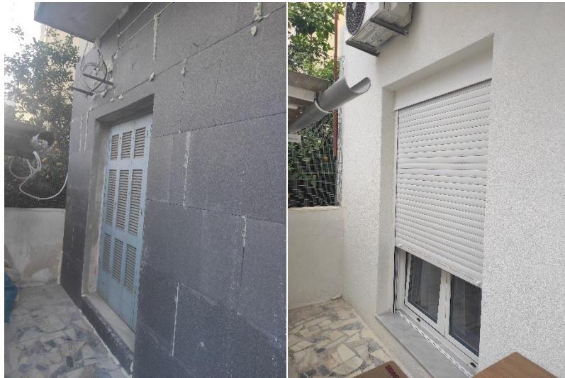
Εικόνα 16 : Θερμογέφυρα εξωτερικής τοιχοποιίας - πλάκα δαπέδου σε επαφή με έδαφος
