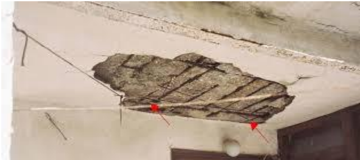
Εικόνα 1: Τυπική βλάβη διάβρωσης οπλισμού. Διακρίνεται η πλήρης αποκόλληση της επικάλυψης, η οποία καθορίζει την επιφάνεια (m 2 ) καθαίρεσης και τον όγκο (m 3 ) του απαιτούμενου επισκευαστικού κονιάματος (Πηγή, Πανεπιστήμιο Πατρών, Διάβρωση Οπλισμένου Σκυροδέματος)
