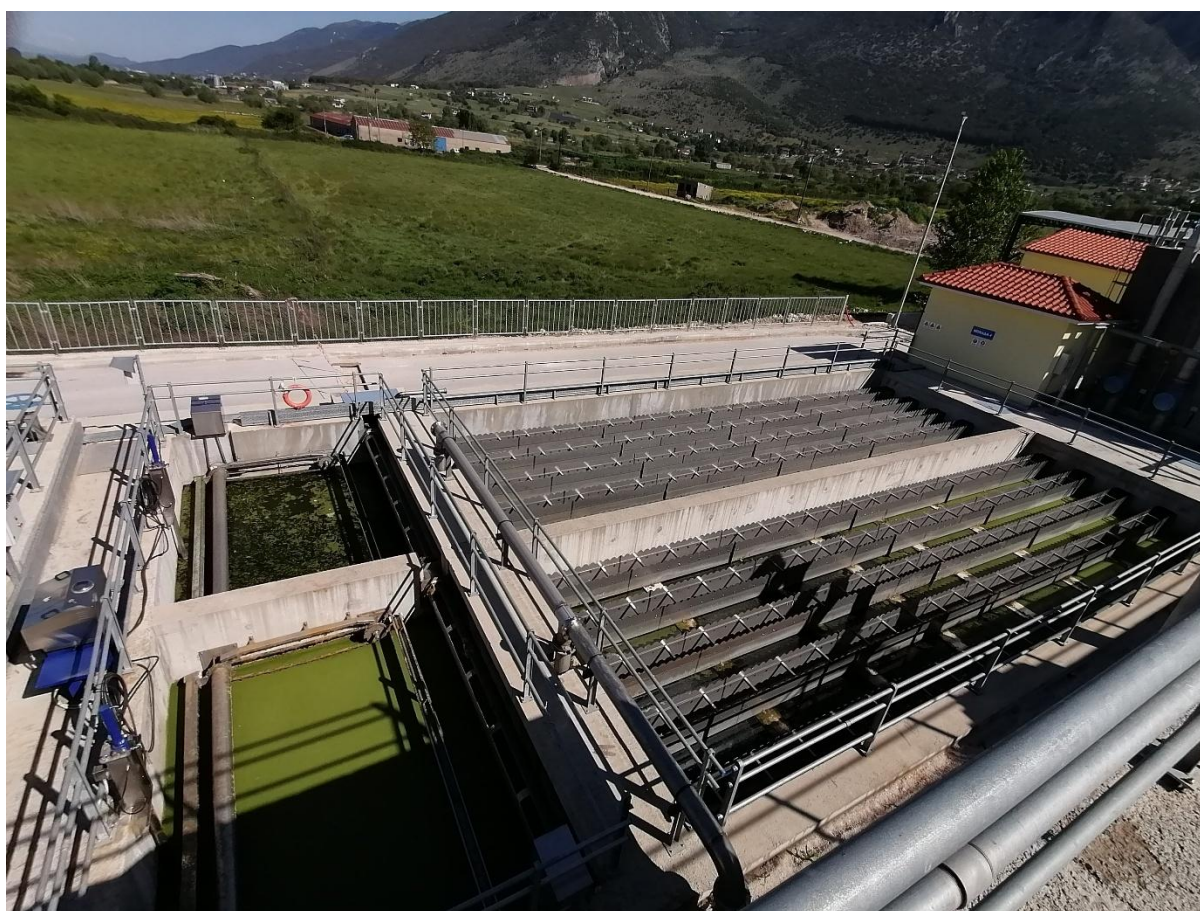
Εικόνα 8 Τριτοβάθμια επεξεργασία δεξαμενές τελικής καθίζησης
