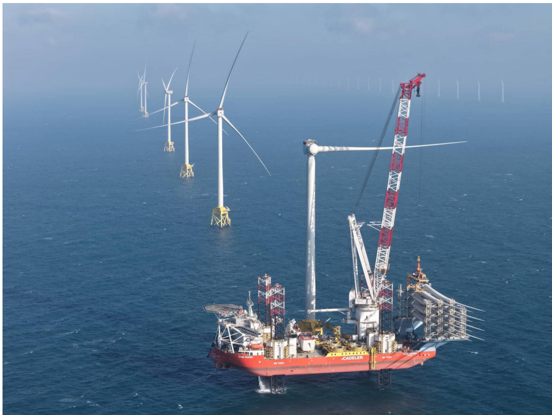
Εικόνα 2: Υπεράκτιο Αιολικό Πάρκο
