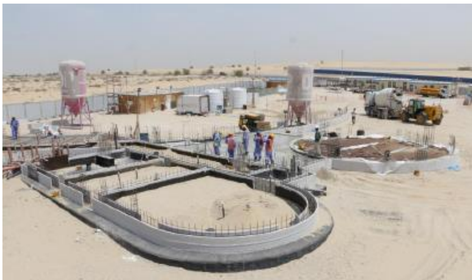
Εικόνα 50: Η κατασκευή των πεδιλοδοκόν της θεμελίωσης του κτιρίου με εκτύπωση του περιγράμματος με τεχνολογία 3D Printing και τοποθέτηση του απαιτούμενου οπλισμού
