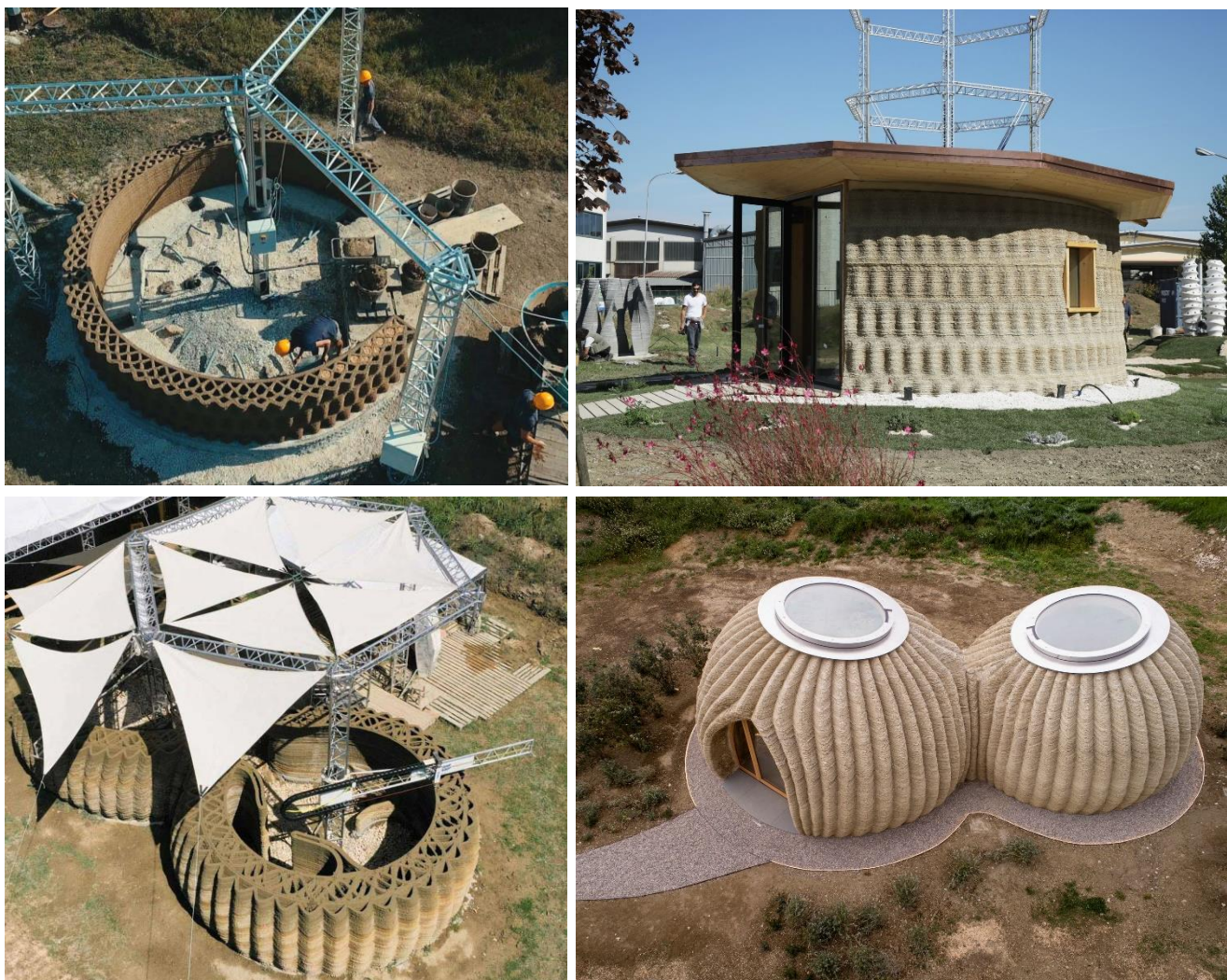
Εικόνα 32: Πάνω: Το έργο «Gaia», κατά της διάρκεια της εκτύπωσης και ολοκληρωμένο. Κάτω: το έργο«TECLA» αντίστοιχα, κατά της διάρκεια της εκτύπωσης και ολοκληρωμένο (πηγή: www.3dwasp.com )
