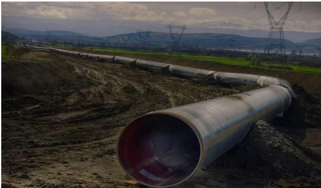
Εικόνα 13. Δίκτυο μονωμένων αγωγών τηλεθέρμανσης στη Κοζάνη.
