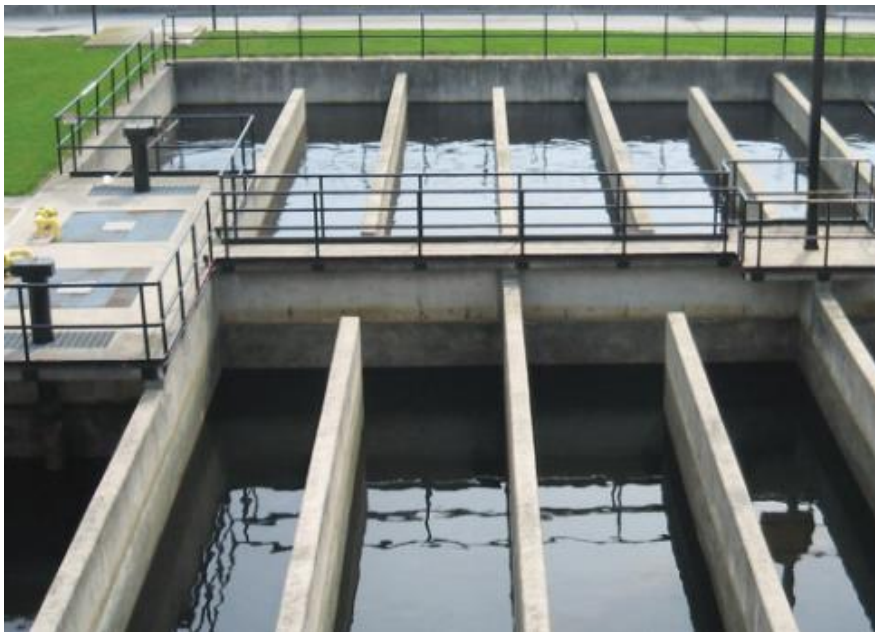
Σχήμα 4.10. Δεξαμενή χλωρίωσης (Enviro Mix, χ.χ.).
