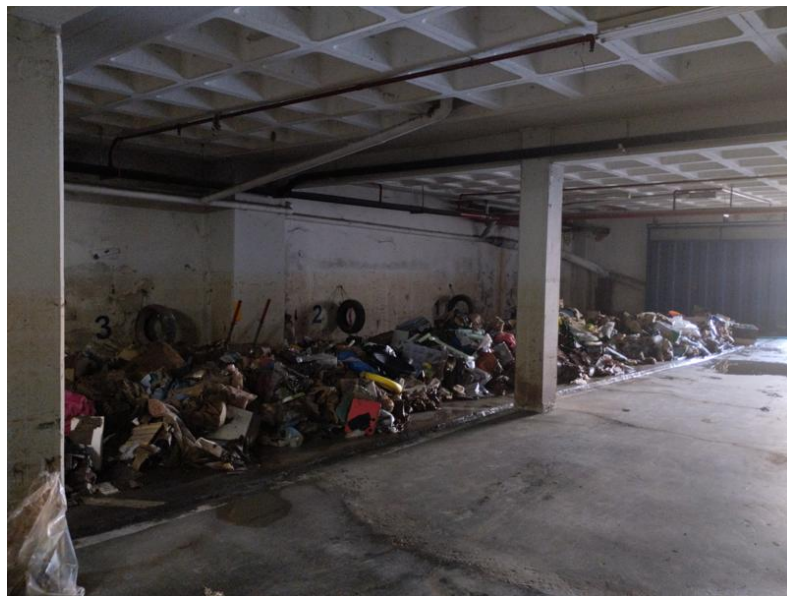
Εικόνα 29: Καταστροφές σε υπόγειο κτιρίου μετά την πλημμύρα. Πηγή: ίδια λήψη (2023)
