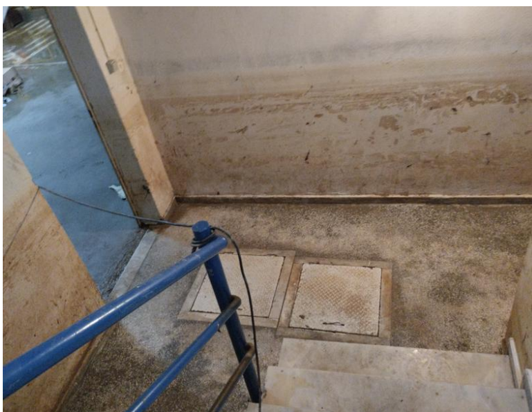
Εικόνα 25: Υπόγειο κτιρίου μετά την πλημμύρα. Πηγή: ίδια λήψη (2023)
