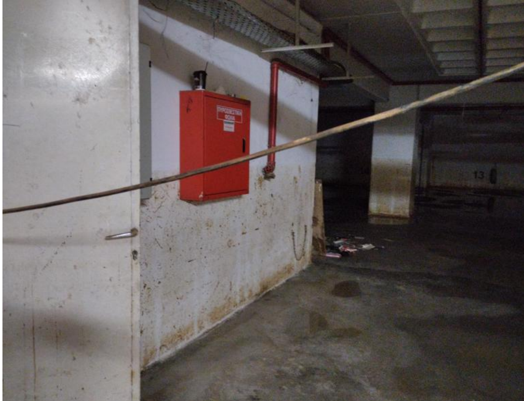
Εικόνα 27: Πλημμυρισμένο υπόγειο κτιρίου. Πηγή: ίδια λήψη (2023)
