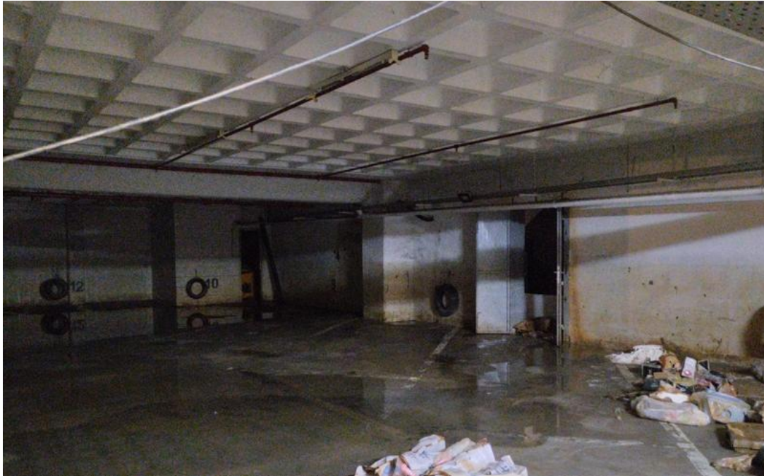
Εικόνα 26: Καταστροφές σε υπόγειο κτιρίου μετά την πλημμύρα. Πηγή: ίδια λήψη (2023)
