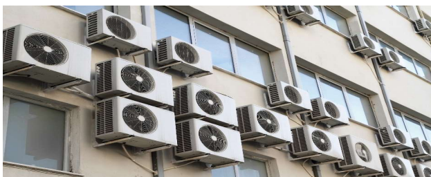
Εικόνα 6 Εξωτερικές κλιματιστικές μονάδες
