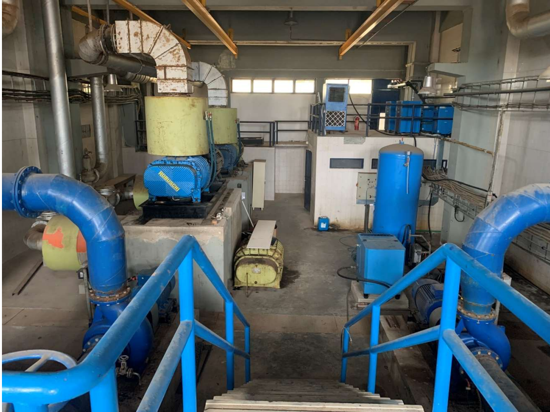
Εικόνα 6: Μηχανοστάσιο αντίστροφης πλύσης φίλτρων.
