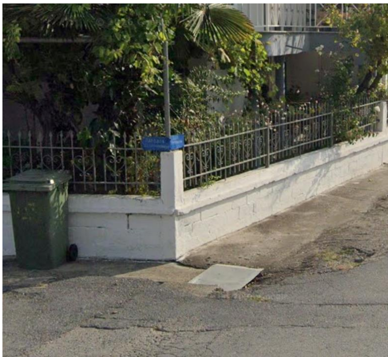
Εικόνα 49 - Ρωγμές σε περίφραξη κατοικίας και καθίζηση (προσωπικό αρχείο)
