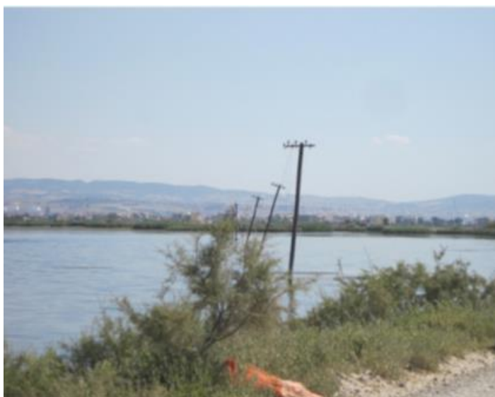
Εικόνα 11 - Επιπτώσεις της εδαφικής καθίζησης στην περιοχή του Καλοχωρίου: βλάβες στο δίκτυο ηλεκτροδότησης. (Svigkas N. et al, 2016)
