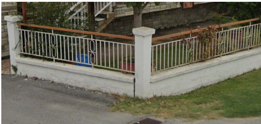
Εικόνα 27 - Ρωγμές σε περίφραξη κατοικίας (προσωπικό αρχείο)
