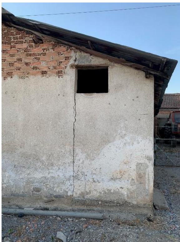
Εικόνα 52 - Ρωγμές σε τοιχοποιία αποθήκης (προσωπικό αρχείο)
