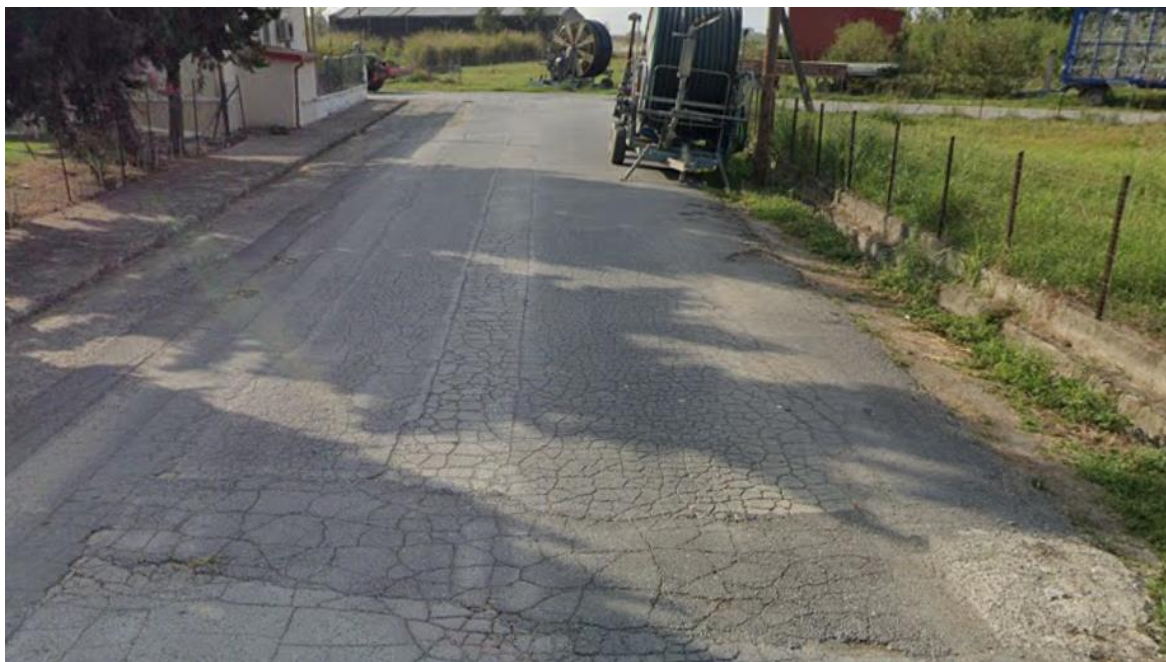
Εικόνα 48 - Ρωγμές στο οδικό δίκτυο (προσωπικό αρχείο)
