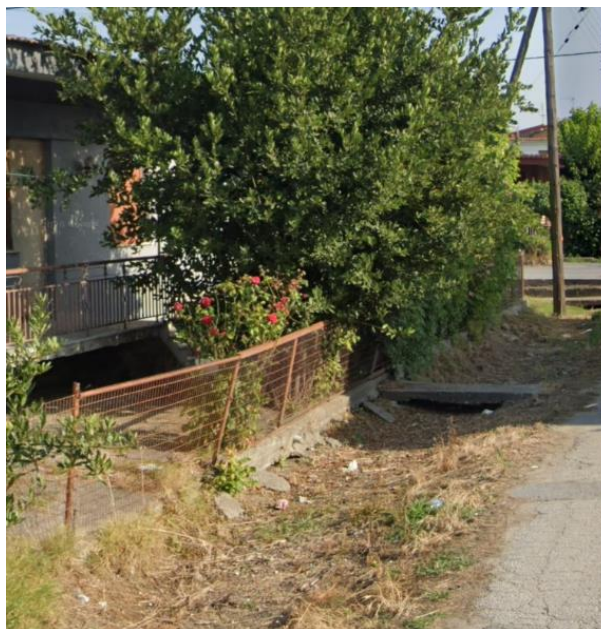
Εικόνα 28 - Καθίζηση και παραμόρφωση περίφραξης λόγω εδαφικής υποχώρησης (προσωπικό αρχείο)
