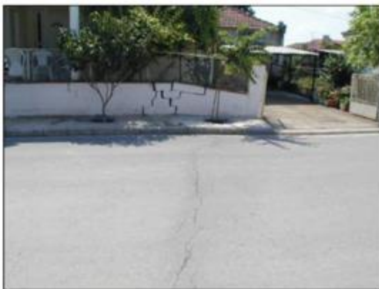
Εικόνα 17 - Ρωγμές στην τοιχοποιία περίφραξης στον οικισμό της Χάλκης (Κεραμοπούλου Β., 2014)
