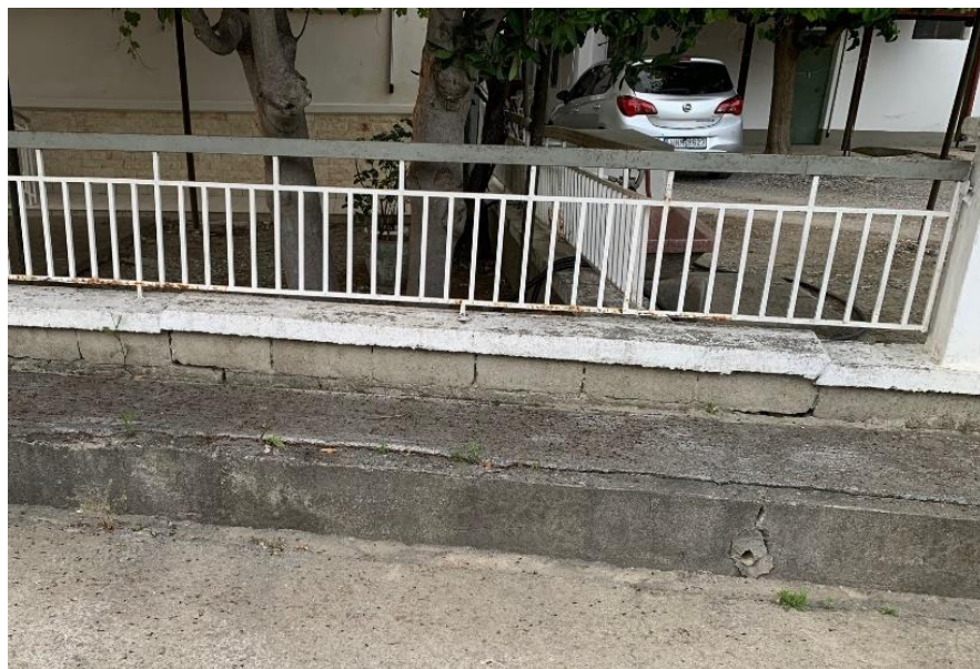
Εικόνα 32 - Ρωγμές σε περίφραξη κατοικίας (προσωπικό αρχείο)
