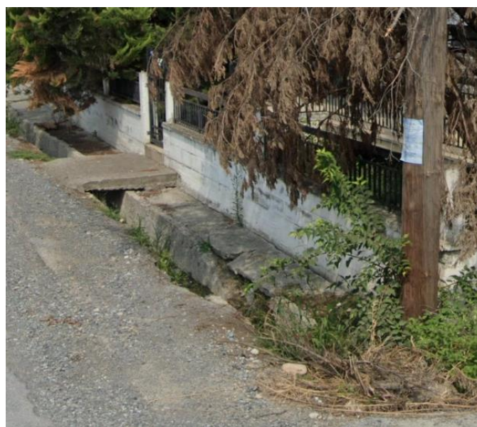
Εικόνα 46 - Ρωγμές σε πεζοδρόμιο (προσωπικό αρχείο)
