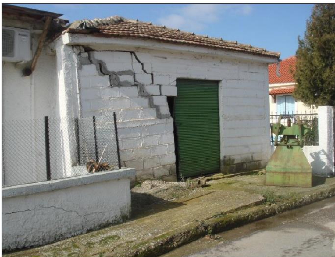
Εικόνα 16 - Ρηγματώσεις στην τοιχοποιία κτιρίου στην περιοχή Σταυρού του δυτικού Θεσσαλικού κάμπου (Σιδέρη Δ., 2016)
