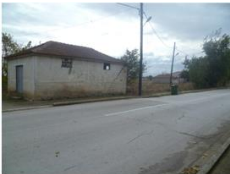
Εικόνα 19 - Εδαφικές διαρρήξεις στο οδόστρωμα και ρωγμές στην τοιχοποιία περίφραξης στον οικισμό της Χάλκης (Κεραμοπούλου Β., 2014)
