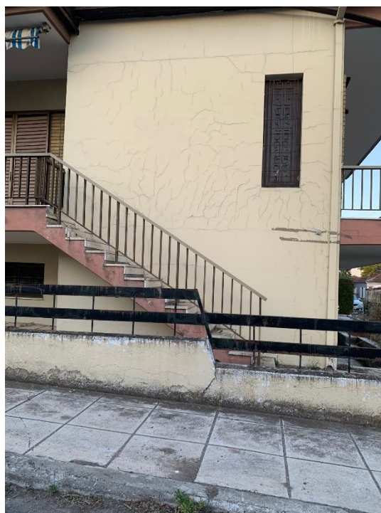
Εικόνα 54 - Ρωγμές σε περίφραξη και σε τοιχοποιία κατοικίας (προσωπικό αρχείο)
