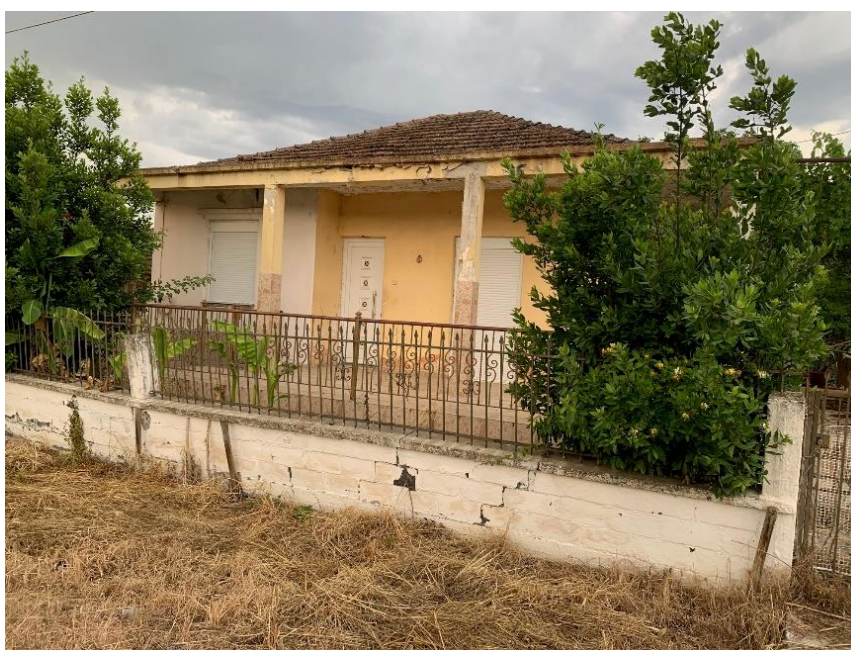
Εικόνα 30 - Ρωγμές σε περίφραξη κατοικίας και καθίζηση (προσωπικό αρχείο)
