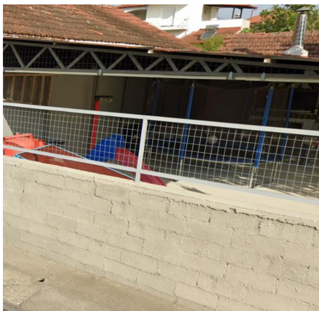
Εικόνα 50 - Ρωγμές σε περίφραξη κατοικίας (προσωπικό αρχείο)
