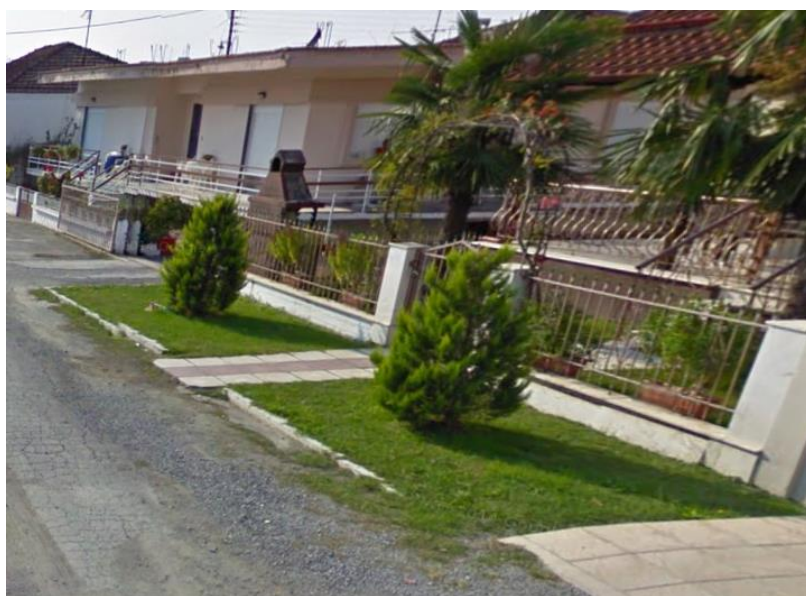
Εικόνα 41 - Καθίζηση και παραμόρφωση περίφραξης λόγω εδαφικής υποχώρησης (προσωπικό αρχείο)
