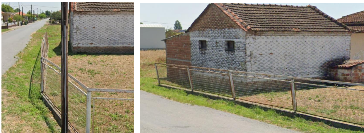
Εικόνα 35 - Καθίζηση και παραμόρφωση περίφραξης λόγω εδαφικής υποχώρησης (προσωπικό αρχείο)
