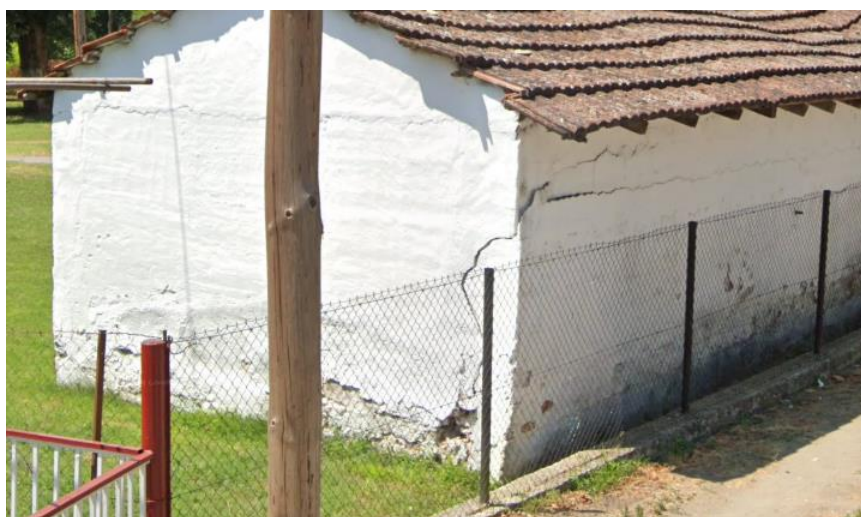
Εικόνα 29 - Ρωγμές στην τοιχοποιία αποθήκης (προσωπικό αρχείο)
