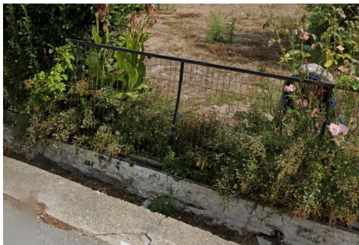
Εικόνα 38 - Ρωγμές σε περίφραξη κατοικίας (προσωπικό αρχείο)
