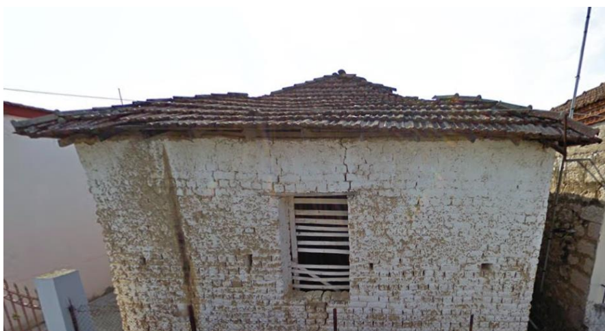
Εικόνα 39 - Ρωγμές σε τοιχοποιία αποθήκης (προσωπικό αρχείο)
