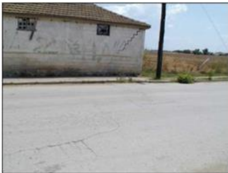
Εικόνα 20 - Εδαφικές διαρρήξεις στο οδόστρωμα και ρωγμές στην τοιχοποιία περίφραξης στον οικισμό της Χάλκης (Κεραμοπούλου Β., 2014)
