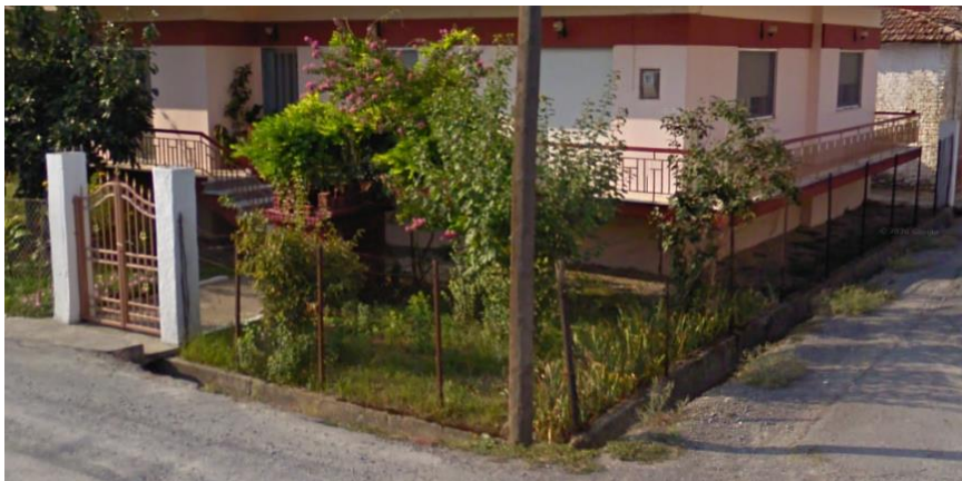
Εικόνα 40 - Καθίζηση και παραμόρφωση περίφραξης λόγω εδαφικής υποχώρησης (προσωπικό αρχείο)
