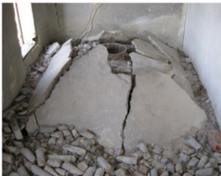
Εικόνα 12 - Επιπτώσεις της εδαφικής καθίζησης στην περιοχή του Καλοχωρίου: ανύψωση σωληνώσεων. (Svigkas N. et al, 2016)
