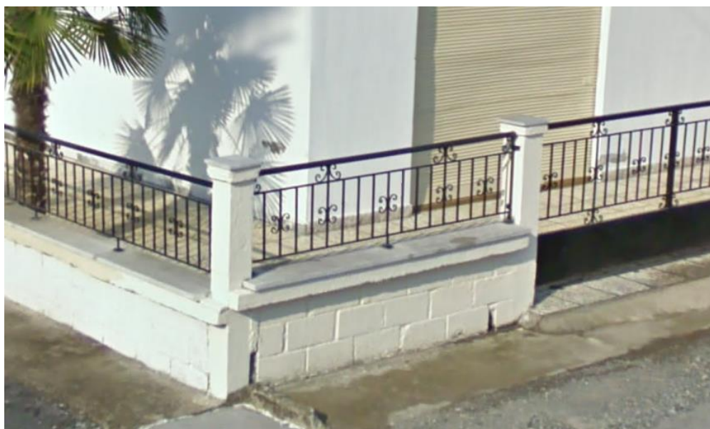
Εικόνα 42 - Ρωγμές σε περίφραξη κατοικίας (προσωπικό αρχείο)
