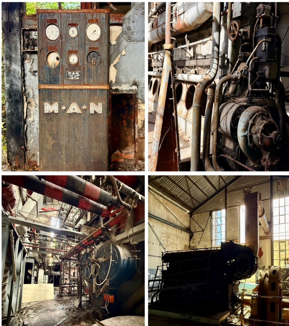
Εικόνα 4: Ο μοναδικός μηχανολογικός εξοπλισμός που έχει διασωθεί είναι στο μηχανοστάσιο της Πειραικής Πατραϊκής (Φωτ. Βασιλική Δρακούλη, 30 Οκτωβρίου 2025).
