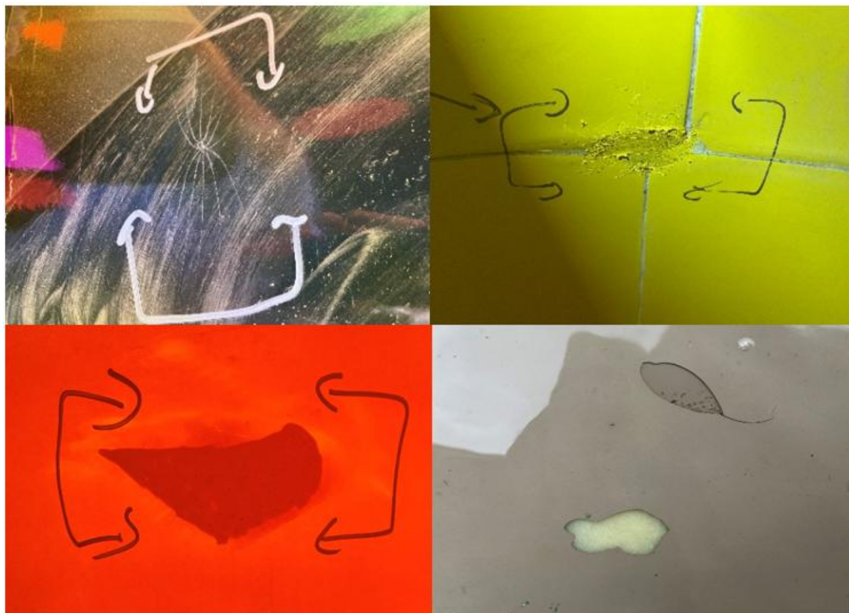
Εικόνα 16: Ενδεικτικές φωτογραφίες από φθορές ή ακατάλληλες επισκευές του FRP πάνω στην επιφάνεια ολίσθησης του χρήστη.
