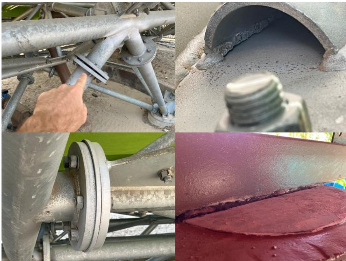
Εικόνα 17: Ενδεικτικές φωτογραφίες ακατάλληλων μηχανικών συνδέσεων και συγκολλήσεων με ανεπαρκή ποιότητα εκτέλεσης στη μεταλλική κατασκευή.
