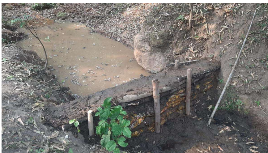
Εικόνα 2. Check dam (Πηγή: SPECIAL ARRANGMENT)
