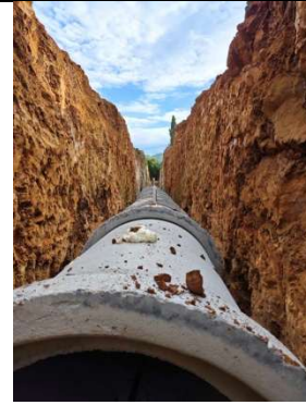
Εικόνα 6. Σωληνωτός τσιμεντένιος αγωγός (βάρους) στο Μαντούδι (Πηγή: ίδια επεξεργασία)
