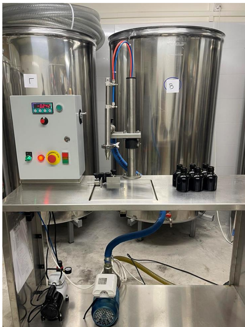
Εικόνα 4.2. Εξοπλισμός τροφοδοσίας και εμφιάλωσης στη μονάδα τυποποίησης
