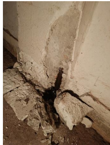
Σχήμα 4.2 Αποκόλληση σκυροδέματος και διάβρωση οπλισμού.
