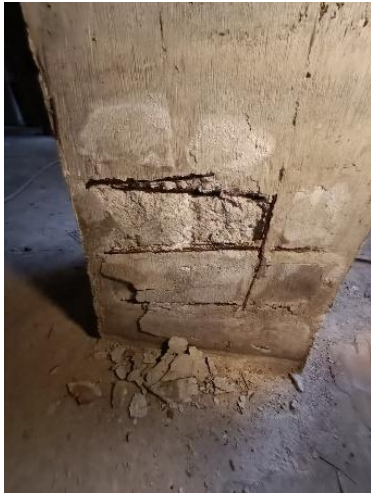
Σχήμα 4.1 Αποκόλληση σκυροδέματος και διάβρωση οπλισμού.
