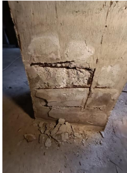
Σχήμα 3.7 Αποσάρθρωση επιχρίσματος σε Υ/Σ και διάβρωση οπλισμού.
