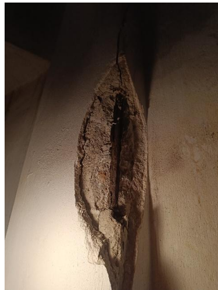
3.9 Αποσάρθρωση επιχρίσματος σε πλάκα και διάβρωση οπλισμού.
