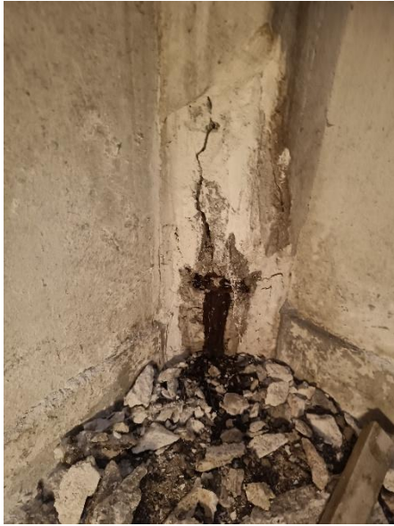
Σχήμα 3.6 Αποσάρθρωση επιχρίσματος σε Υ/Σ και διάβρωση οπλισμού.
