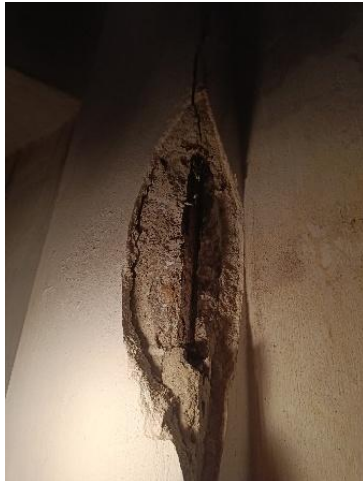
Σχήμα 4.3 Αποκόλληση σκυροδέματος και διάβρωση οπλισμού.
