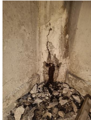
Σχήμα 4.4 Αποκόλληση σκυροδέματος και διάβρωση οπλισμού.
