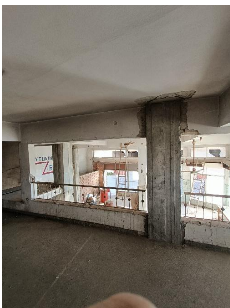
Σχήμα 3.10 Αποσάρθρωση επιχρίσματος σε πλάκα και διάβρωση οπλισμού.
