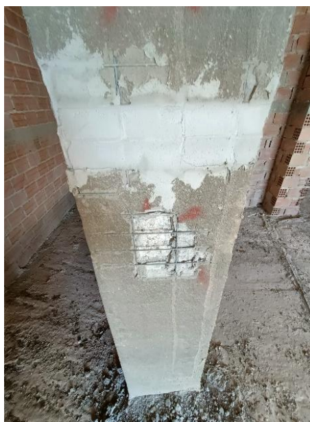
Σχήμα 3.11 Τοπικές επισκευές / κακοτεχνίες..
