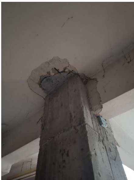
Σχήμα 3.8 Αποσάρθρωση επιχρίσματος σε πλάκα και διάβρωση οπλισμού.
