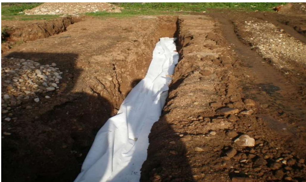
Φωτογραφία 2 : Υπεδάφιο πεδίο διάθεσης
