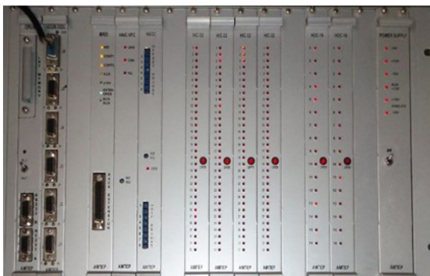
Σχήμα 24 Πρόσωση ενός «νέου» PLC Αντλιοστασίου
