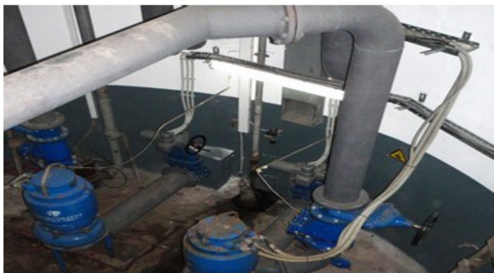
Σχήμα 21 Χώρος αντλιών ενός Αντλιοστασίου
