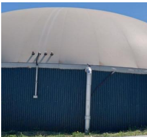
Εικόνα 20 - Σωλήνας εξαγωγής βιοαερίου από το αεροφυλάκιο του αντιδραστήρα μεταχώνευσης (προσωπικό αρχείο, 06/04/2026)
