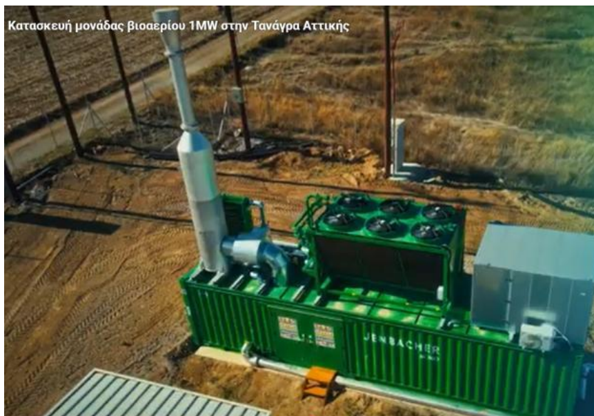
Εικόνα 16 - Μονάδα ΣΗΘ (PK ENERGY, 2026)
