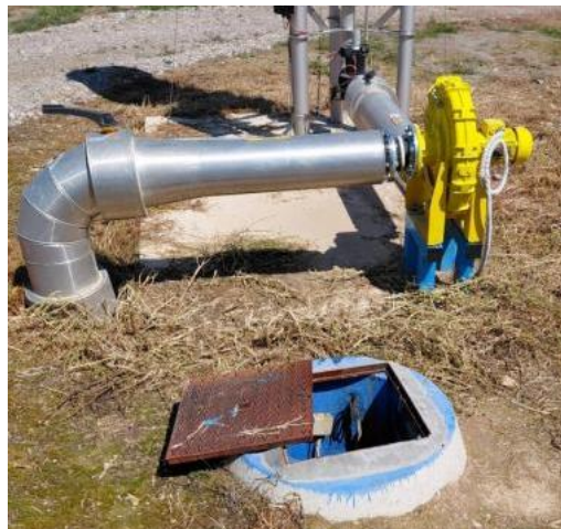
Εικόνα 9 - Φρέαρ συμπυκνωμάτων νερού (προσωπικό αρχείο, 06/04/2026)
