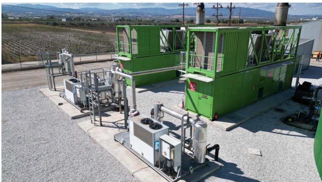
Εικόνα 10: Γεννήτριες παραγωγής ηλεκτρικής ενέργειας 1 MW στη μονάδα «Βιοενεργειακή Νιγρίτας Α.Ε.»
