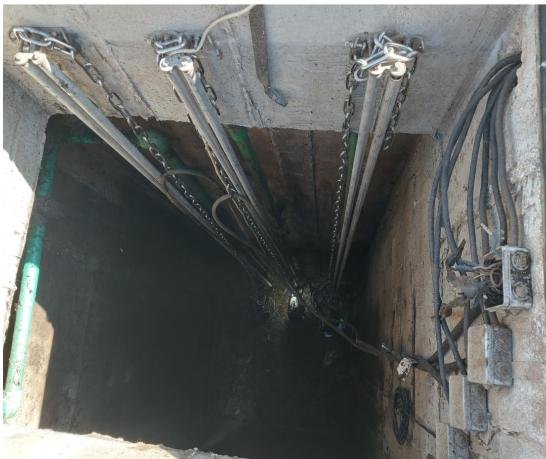
Εικόνα 4-1: Αντλιοστάσιο ανύψωσης εισερχομένων λυμάτων
