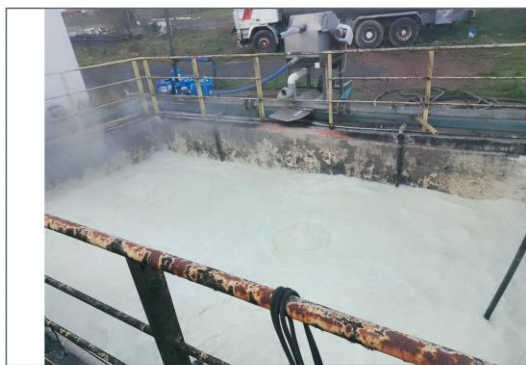
(α) Δεξαμενή εξισορρόπησης
