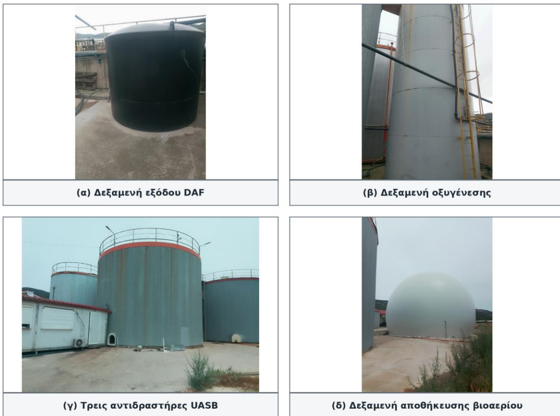
Σχήμα 2.3: Αναερόβια γραμμή και αξιοποίηση βιοαερίου: (α) δεξαμενή εξόδου DAF, (β) δεξαμενή οξυγένησης, (γ) οι τρεις αντιδραστήρες UASB και (δ) δεξαμενή αποθήκευσης βιοαερίου.
