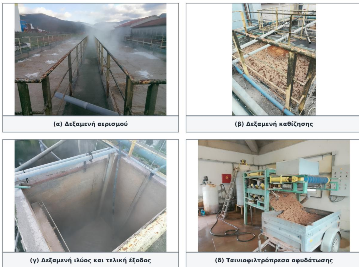
Σχήμα 2.4: Αερόβια επεξεργασία και διαχείριση ιλύος: (α) δεξαμενή αερισμού, (β) δεξαμενή καθίζησης, (γ) δεξαμενή ιλύος και παρακείμενη τελική έξοδος και (δ) ταινιοφιλτρώπρεσα αφυδάτωσης.
