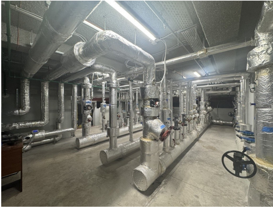
Εικόνα 5.11: Πραγματική άποψη του μηχανοστασίου του συστήματος ψύξης και θέρμανσης νερού με αντλίες θερμότητας για τους εμπορικούς χώρους, στον μεσώροφο, στην περιοχή ελέγχου Α. Πηγή: φωτογραφικό/τεχνικό αρχείο έργου, ιδία επεξεργασία.
