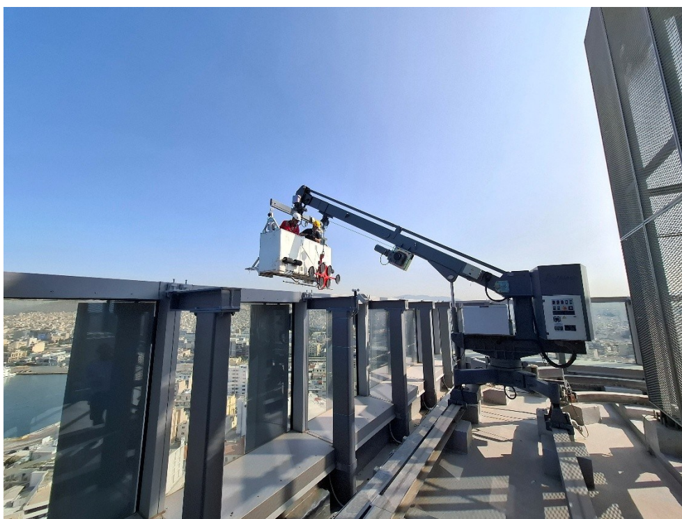
Εικόνα 5.2: Μονάδα συντήρησης όψεων (BMU) στο δώμα του Πύργου Πειραιά, Πηγή: Φωτογραφικό αρχείο έργου / ιδία λήψη [2025].
